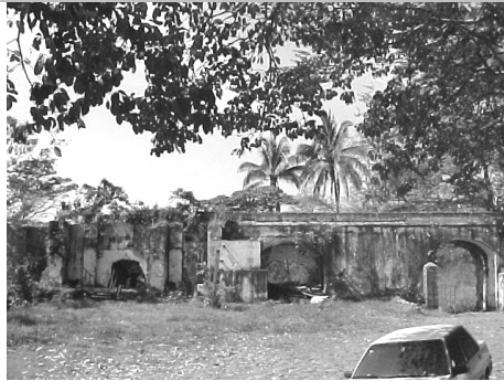
FOTOGRAFÍA No.5: Arcos de medio punto de calicanto y ladrillo, con vegetación por estar abandonado y soterrado parte de las piletas.
