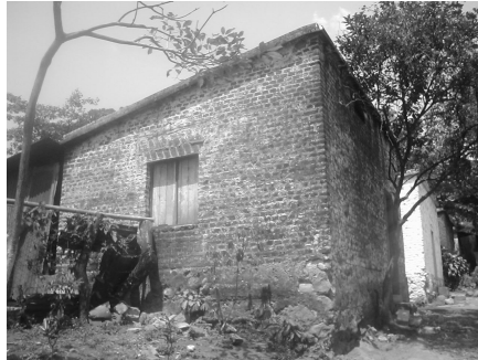
FOTOGRAFIA No.1: RANCHERÍA daños en muros de calicanto, ventana de madera.
