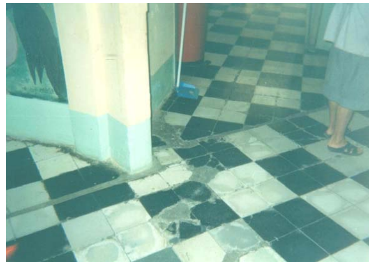
FOTO 6 En la fotografía observamos el deterioro de los pisos por los años y el tráfico pesado.
