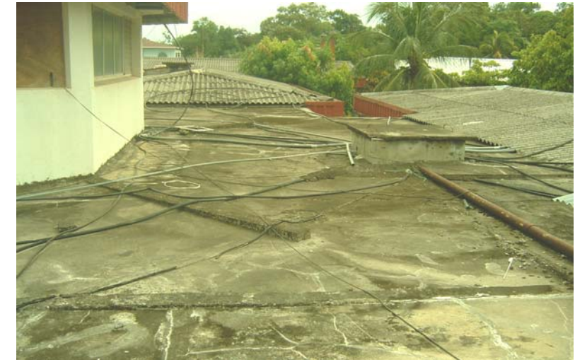
FOTO 15 Terraza del hospital sobre administración en mal estado por falta de mantenimiento tubería de instalaciones sobre losa
