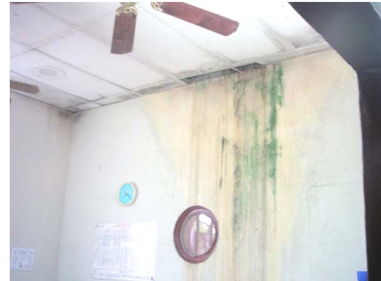
FOTO 12 Filtración de agua en paredes en emergencia.
