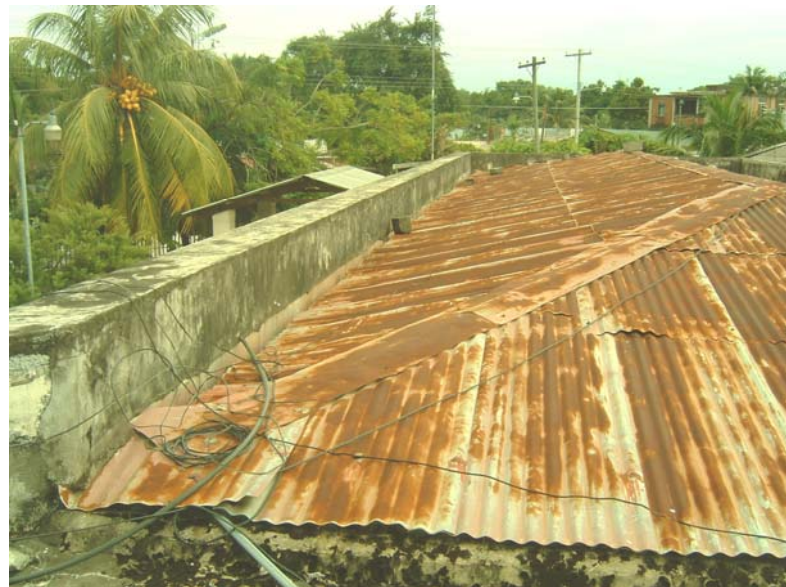
FOTO 14 Techo de intensivo y emergencia en mal estado por los años, se ve falta mantenimiento
