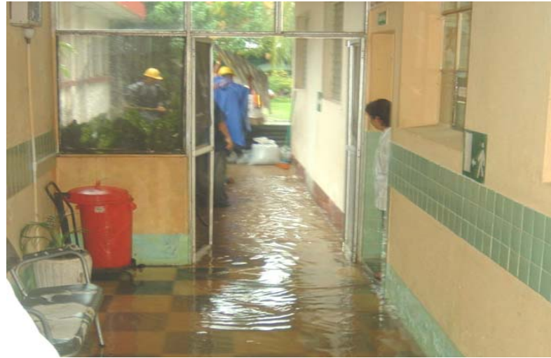
FOTO 13 Inundación tras fuertes lluvias en Noviembre 2004 pasillos de encamamiento y unidad de diagnóstico
