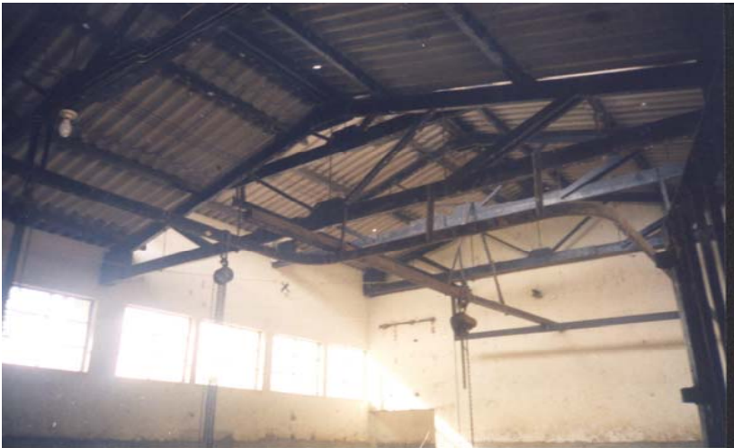
Sistema de faenado aéreo, polipasto en forma de S.
