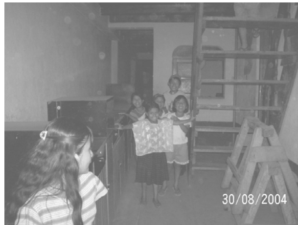
FOTOGRAFIA No. 06 Ingreso principal, en el interior del edificio existen barreras arquitectónicas, que limitan el correcto funcionamiento del centro y dificultan el desplazamiento de los usuarios.
