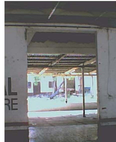
Fotografía 3: Esta es una vista desde el interior, desde el área utilizada como salón municipal, se observan los muros, las columnas, los techos en mal estado, que deben ser reemplazados.
