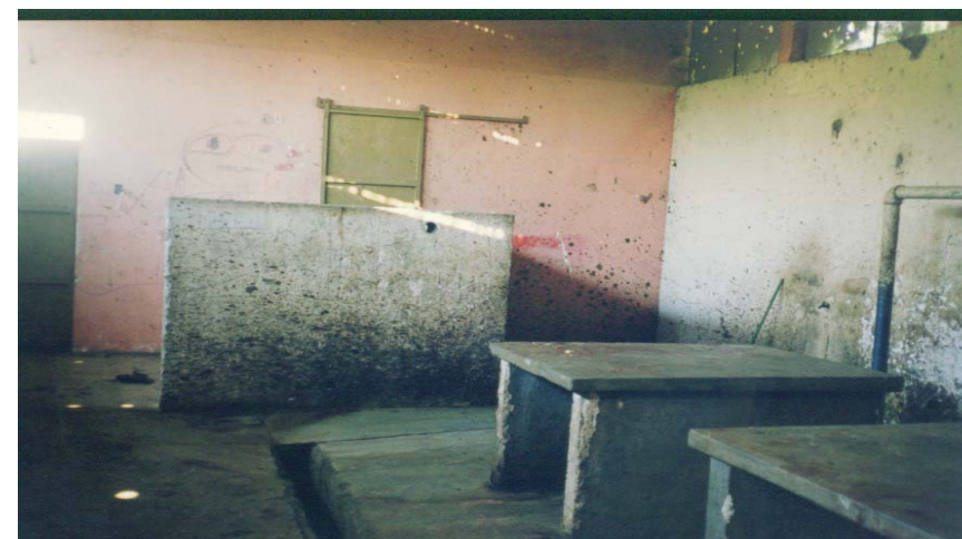
Su área de matarife no es adecuada y hay mala circulación con las mesas de faenado y sin mantenimiento.
