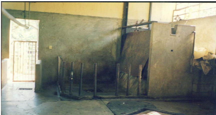
Se aprecia su abandono, está sin mantenimiento y es integrado con salida del producto cárnico.
