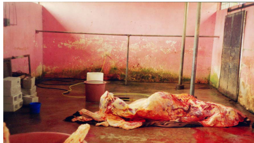
Totalmente contaminado, no cuenta con ningún servicio, observar res en el suelo, block en la playa de matanza y utensilios.
