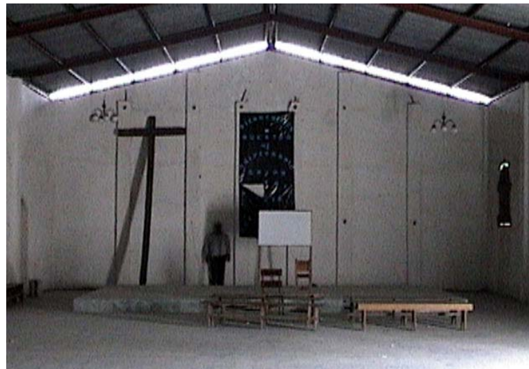
Gráfica 3-15. En esta fotografía se ilustran varios elementos. Primero, la plataforma ubicada en el fondo de la nave. Segundo, existen un par de lámparas colgantes sin patrón alguno para su colocación. Tercero, la cubierta deja una abertura en la parte superior del muro este de la nave. Fuente: elaboración propia. Noviembre 2001.
