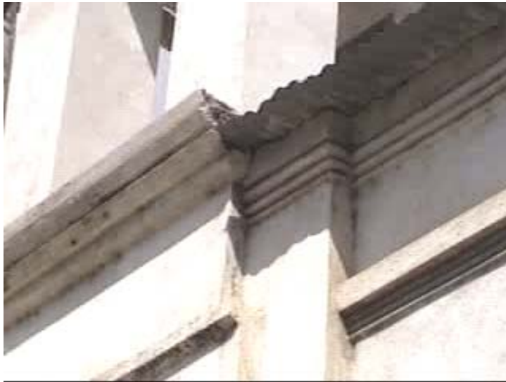
Gráfica 3-7. Detalle de la junta entre la fachada y los muros de la nave del Calvario. Se puede apreciar la forma en que la lámina tiene su vertiente, además se nota la irregularidad y desorden en cuanto a las molduras. Se observa, asimismo, que ninguna moldura tiene tratamiento de gota. Fuente: elaboración propia. Noviembre 2001.
