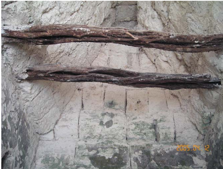
Ilustración 65 Daño por ciclos de humedad - secado, cámara principal, edificio E, hacia el sur
