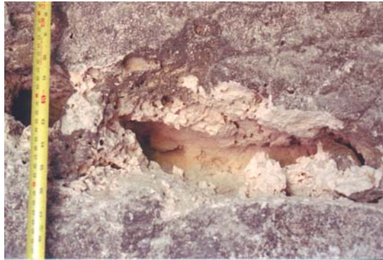
Ilustración 59 Galerías en un bloque de caliza producidas por avispas, edificio E, elaboración propia.
