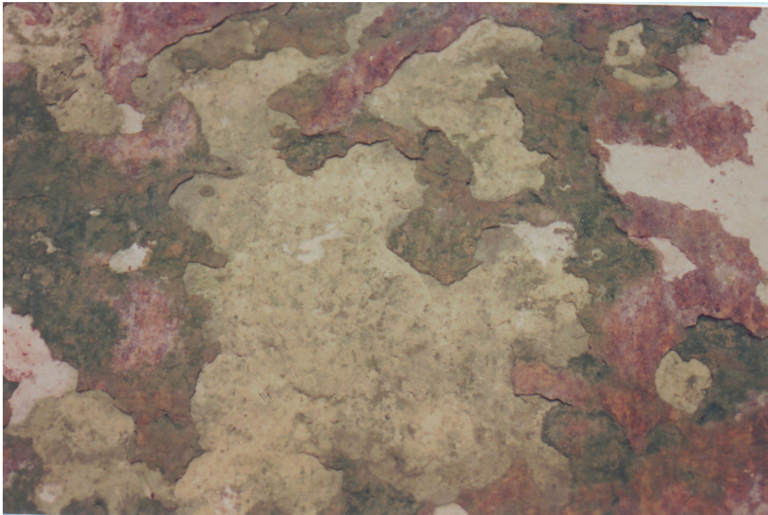
Ilustración 71 Daño por humedad, desprendimiento de capa de estuco, exfoliación, y colonias de algas. Pared sur, cámara principal, edificio E
