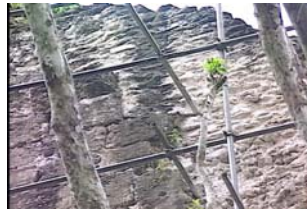
Ilustración 77 Reducción a yeso de la piedra caliza en remate de templo en edificio E (elaboración propia)
