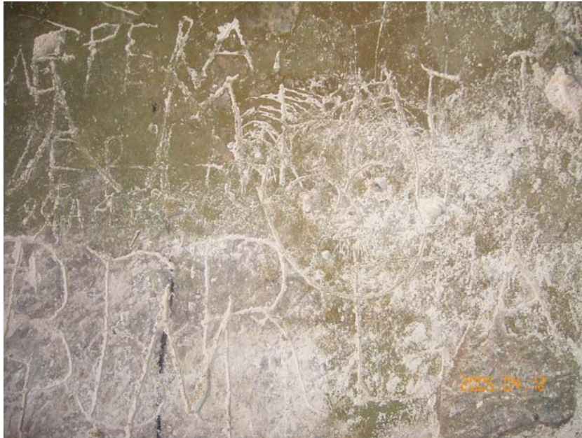
Ilustración 64 Daño por seres humanos, edificio E, muro oeste, cámara principal
