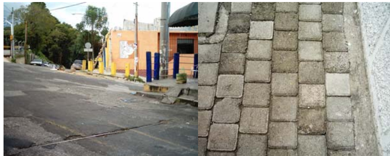
Asfalto típico en todo el área, que requiere de constante mantenimiento.
