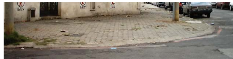
Existencia de adoquín en algunas esquinas que rompen con la integración, ya que no cuentan con el debido mantenimiento.
