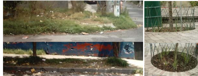
Descuido total de banquetas y sus elementos como bordillos y alcorques, solamente se ven con un cuidado especial los colocados recientemente en Cuatro Grados Norte.
