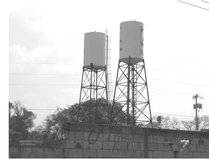
Vista de Tanques de Distribución de Agua Potable para el Asentamiento “Mario Alioto López Sánchez”, con lo cual se abastece toda la población.
