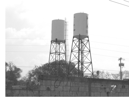
Vista de Tanques de Distribución de Agua Potable para el Asentamiento “Mario Alioto López Sánchez”, con lo cual se abastece toda la población.
