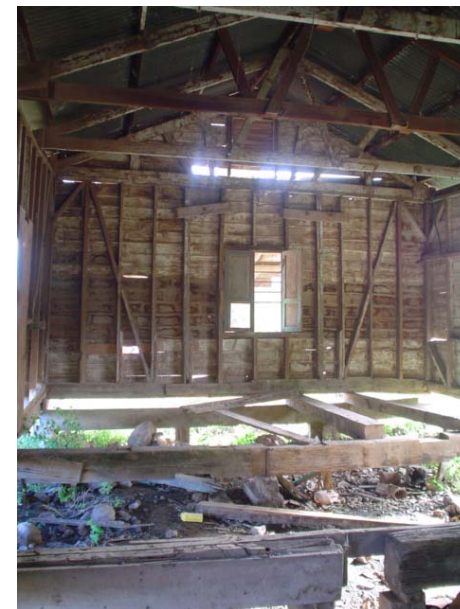
3 Foto 30. Vista Interior de la Estación Agua Blanca. Fuente: Jorge Maldonado, Octubre 2,004
