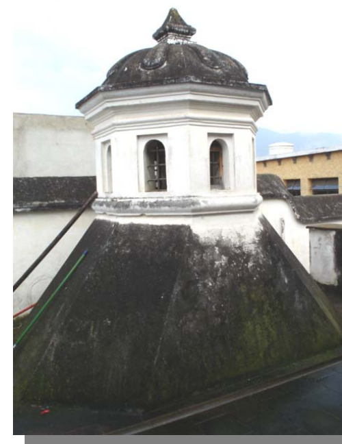
FOTOGRAFÍA 62 Los acabados de las linternillas se han degradado por los efectos de hongos y microflora.
