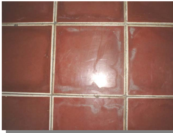
FOTOGRAFÍA 47 Los pisos de cemento líquido se encuentran desnivelados y presentan manchas por los efectos de la humedad.
