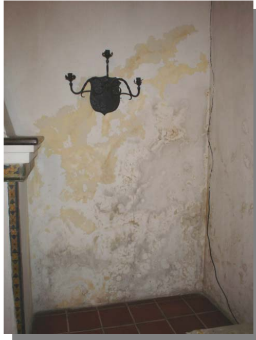
FOTOGRAFÍA 43 En los muros colindantes de la planta baja son notorios los efectos de la humedad como manchas y sales.
