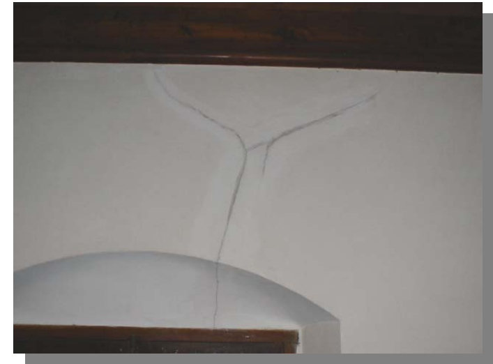
FOTOGRAFÍA 46 En algunos casos se han resanado grietas pero únicamente de forma superficial en los acabados.
