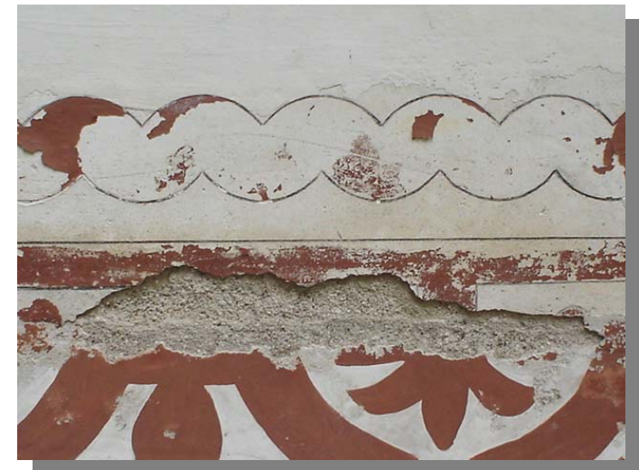
FOTOGRAFÍA 48 La humedad en los muros ha provocado la erosión y desprendimiento de repellos a la altura de los zócalos. Daño en pintura mural.
