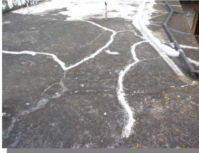
FOTOGRAFÍA 61 La cubierta de terraza española presenta fisuras que fueron resanadas recientemente.
