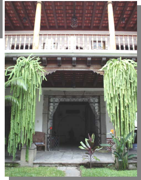
FOTOGRAFÍA 40 La colocación de plantas en las columnas de madera ha generado la proliferación de hongos.
