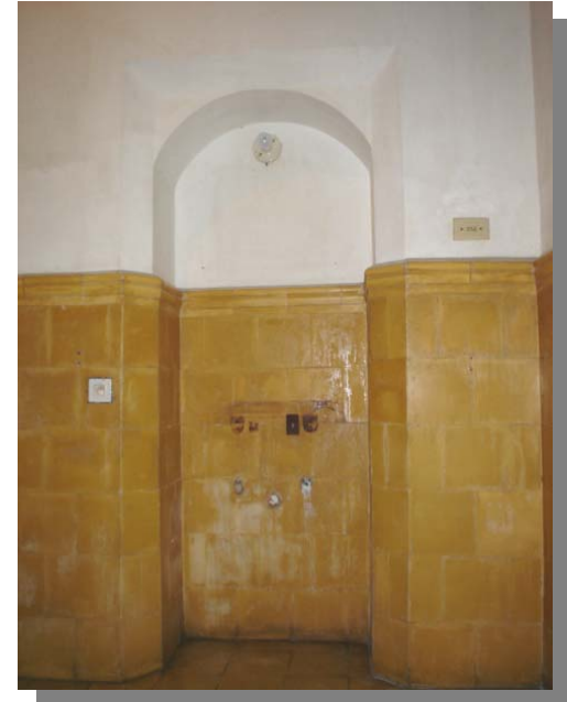
FOTOGRAFÍA 58 Los servicios sanitarios agregados tienen integración de azulejos y los artefactos sanitarios ya fueron liberados.
