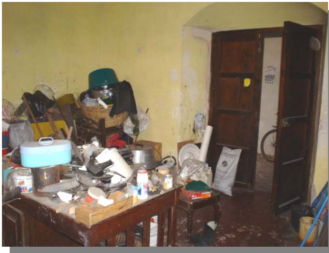
FOTOGRAFÍA 55 En la planta baja existen espacios usados para bodegas, presentando estos mayores deterioros.
