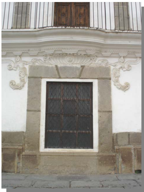
FOTOGRAFÍA 35 Las dos puertas laterales de la planta baja de la fachada fueron modificadas y convertidas en ventanas.
