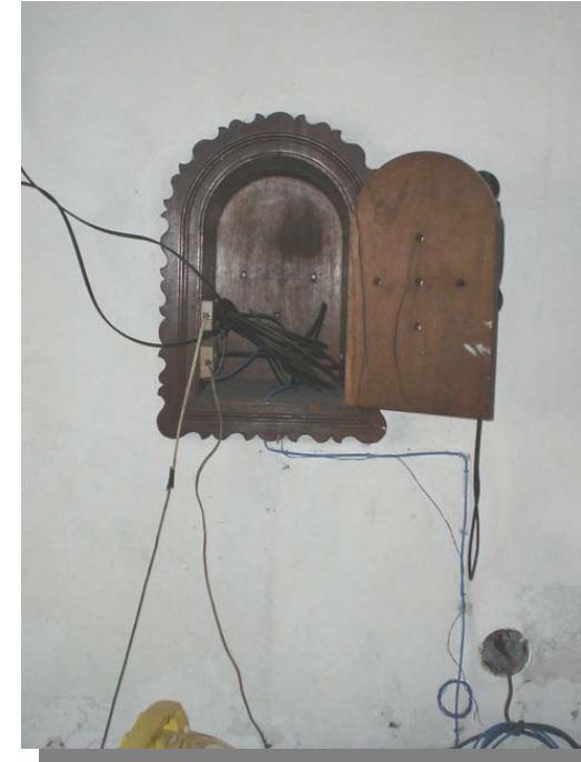
FOTOGRAFÍA 42 Elementos adosados en los muros y cables de instalaciones colocados caprichosamente.
