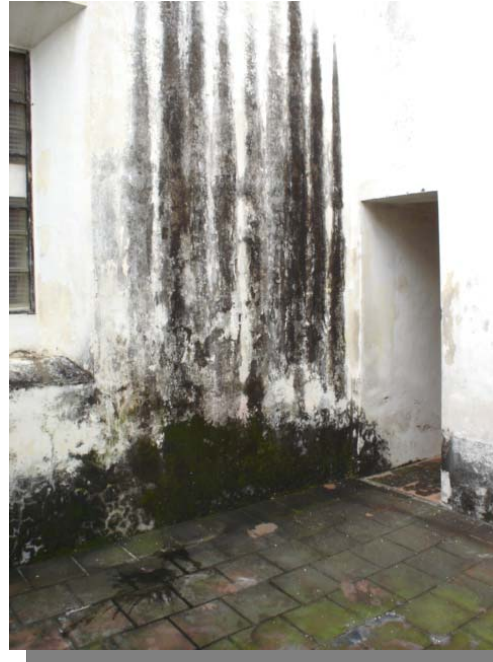
FOTOGRAFÍA 57 Los muros en el patio posterior presentan manchas y hongos producidas por la lluvia.
