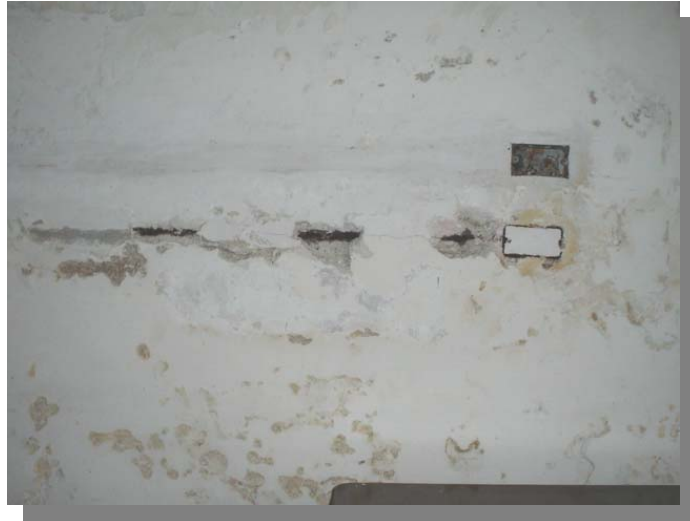
FOTOGRAFÍA 41 Desprendimiento de material en áreas donde se integró poliducto para instalaciones eléctricas.
