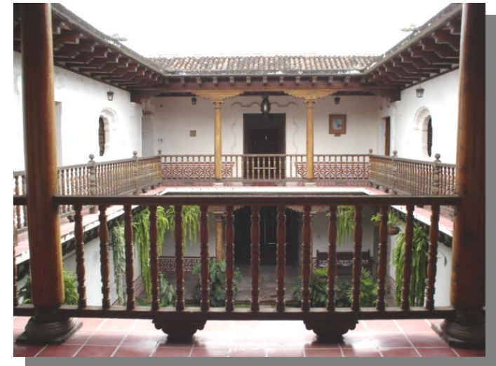
FOTOGRAFÍA 56 Los barandales originales de hierro forjado de las galerías fueron sustituidos por bolillos de madera.
