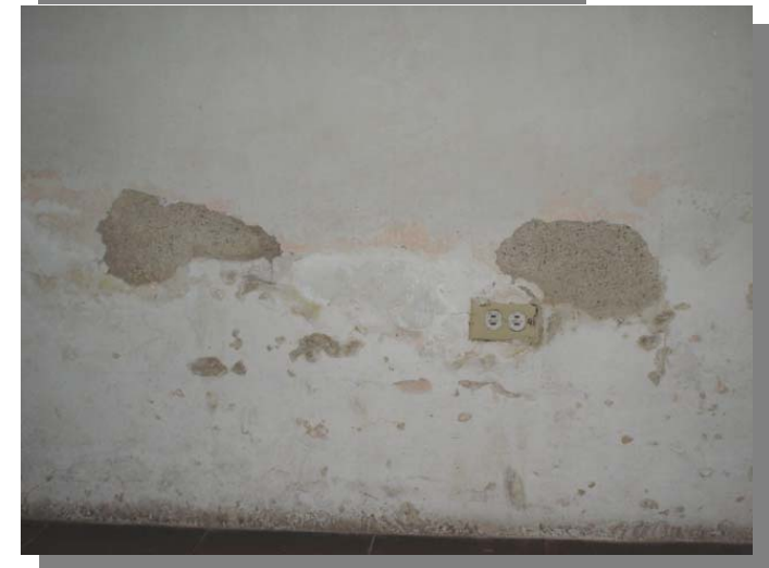
FOTOGRAFÍA 44 Se han realizado trabajos de reposición de material en muros donde existe desprendimiento de repellos.
