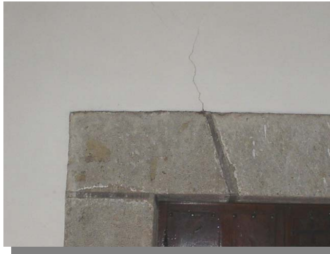
FOTOGRAFÍA 45 Existen fisuras en diagonal sobre los dinteles de marcos de algunas puertas de la planta baja.
