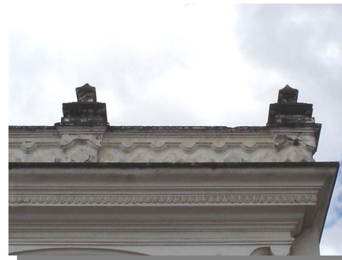
FOTOGRAFÍA 36 Los pináculos de remate en el pretil de la cornisa se encuentran cubiertos por hongos producidos por los efectos de la humedad.
