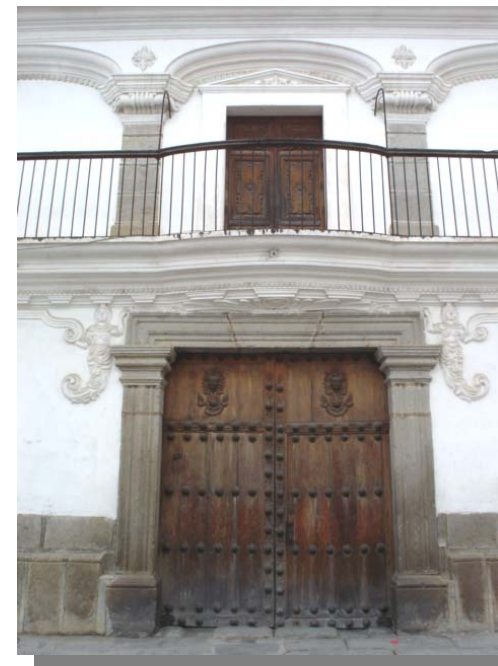
FOTOGRAFÍA 34 La puerta de ingreso principal, en su parte inferior presenta daños por humedad y decoloración por soleamiento.
