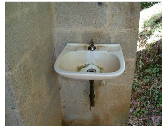
Foto No. 3.12 Agua entubada
