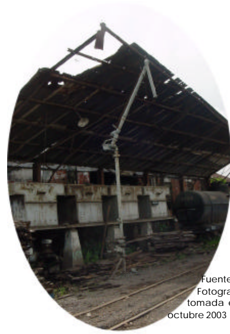
Fotografía -98 Destrucción parcial de cubiertas
