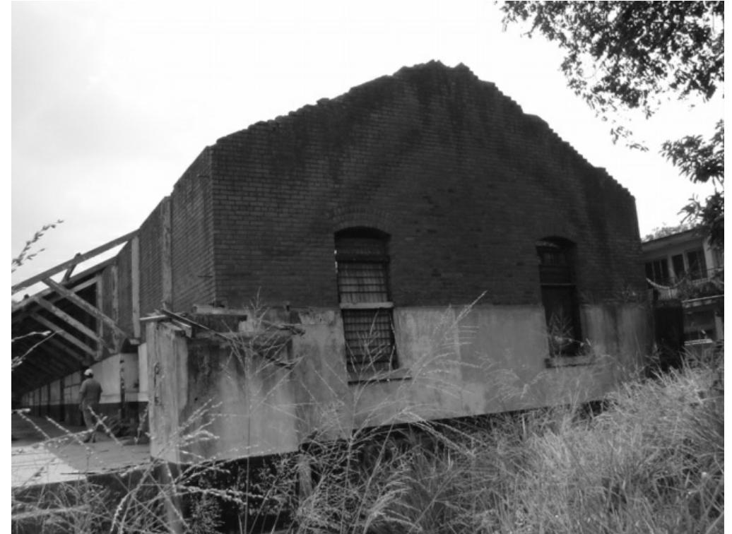
Foto 11: Como se puede observar en la fotografía el estado actual de la bodega se encuentra sin la parte del techo, sin el cleristorio que era parte de su construcción original, se observa parte del rosetón. Fuente Juan Mejicanos y Jorge Xiquin (abril 2004)
