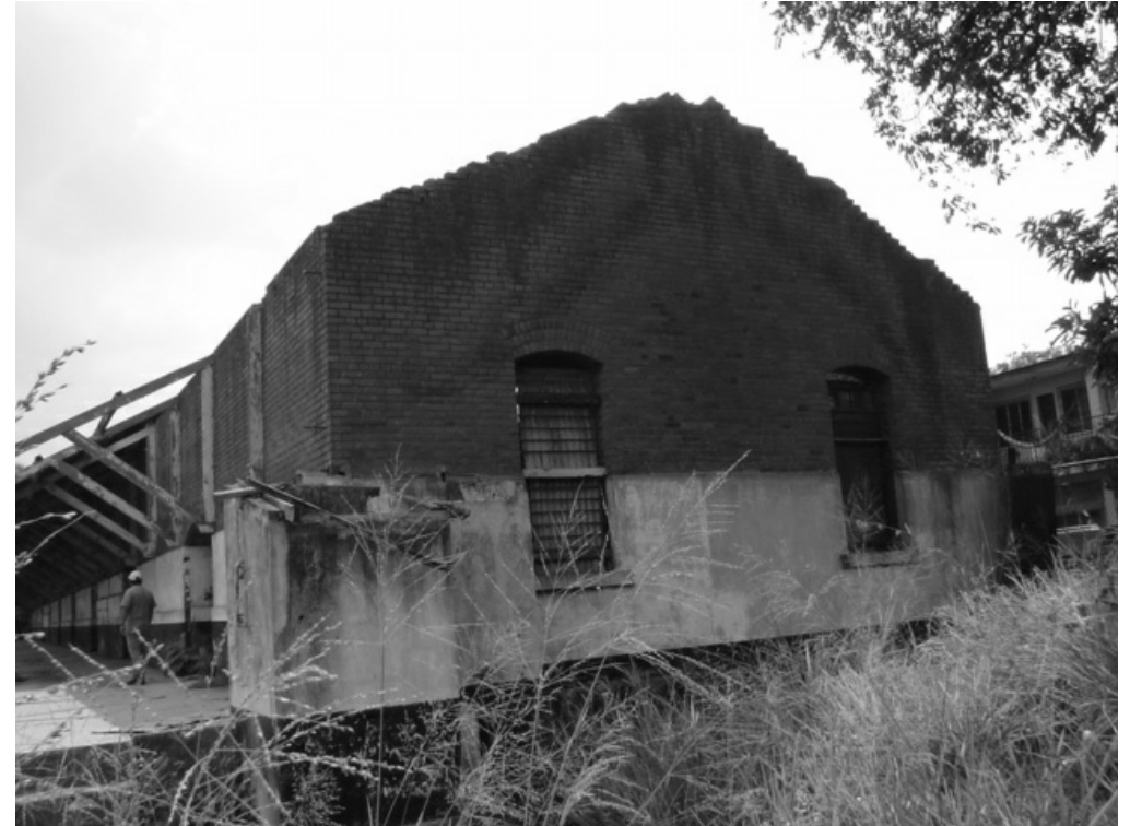
Foto 11: Como se puede observar en la fotografía el estado actual de la bodega se encuentra sin la parte del techo, sin el cleristorio que era parte de su construcción original, se observa parte del rosetón. Fuente Juan Mejicanos y Jorge Xiquin (abril 2004)
