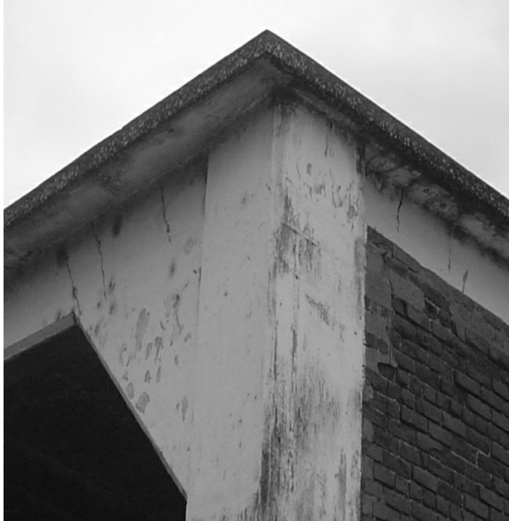
Foto 19: En la fotografía se observa la falla a corte que sufre la ménsula, como lo erosionado que se encuentra el ladrillo por la lluvia y la falta de mantenimiento. Fuente Juan Mejicanos y Jorge Xiquin.
