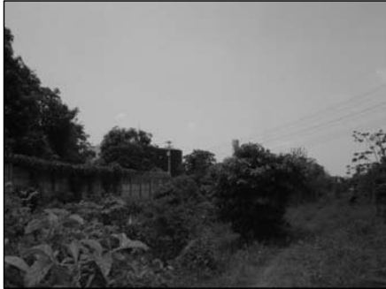
FOTO 39: EN LA FOTOGRAFÍA SE APRECIA EL ABANDONO EN EL QUE SE ENCUENTRA EL DECHO DE VÍA, EL CUAL NO TIENE NUNGUNA DELIMITACIÓN YA QUE LA HIERBA Y VEGETACIÓN NO LO PERMITEN LOCALIZARLA, EN ESTE TRAMO GENERALMENTE SE ENCUENTRA ABANDONADA Y SIN VESTIGIOS DE LA LÍNEA FERREA(FUENTE JUAN MEJICANOS Y JORGE XIQUÍN)
