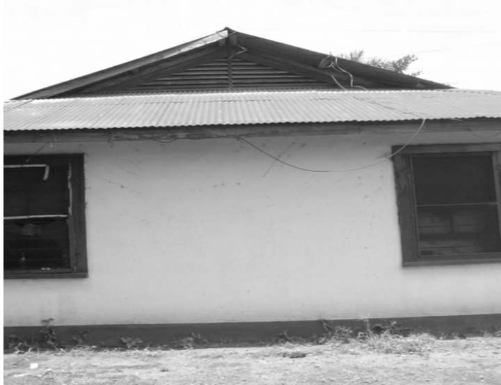
Foto 7: Se puede observar en la fotografía una de la vivienda que se encuentran dentro de la estación del ferrocarril, la cual se encuentra ocupada. Fuente: elaboración propia.
