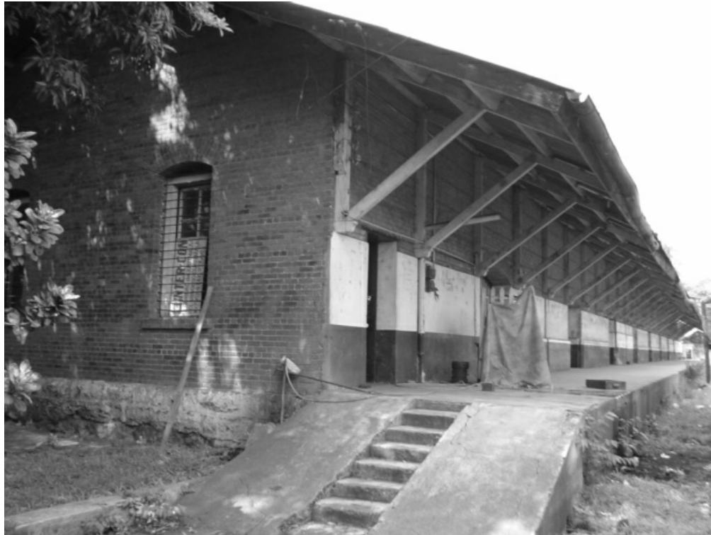
Foto 12: Vista sur de la bodega, se puede observar el estado actual y parcialmente el deterioro de algunos elementos de sustentación de la estructura del techo. Fuente Juan Mejicanos y Jorge Xiquin (abril 2004)
