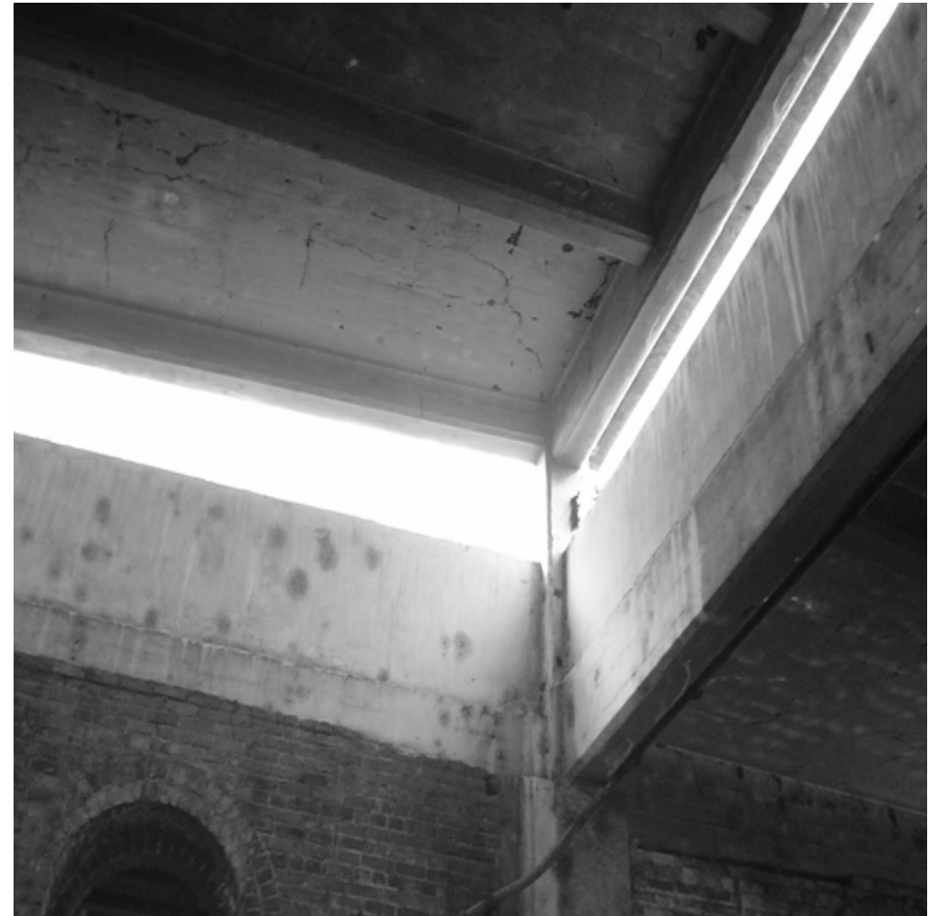
Foto 18: En la fotografía se puede observar parte de la losa, la condición en que se encuentra, también se puede ver el hongo que la está contaminando. Fuente Juan Mejicanos y Jorge Xiquin
