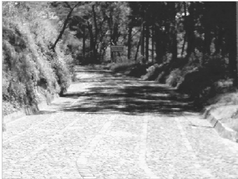
ESTADO ACCESO VEHICULAR
