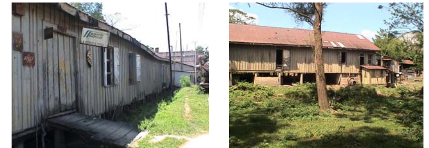
Foto No. 145 Vista Frontal del Comisariato, únicamente el área de cocina esta habitada. Foto No. 146 Vista Trasera o posterior del Comisariato.
