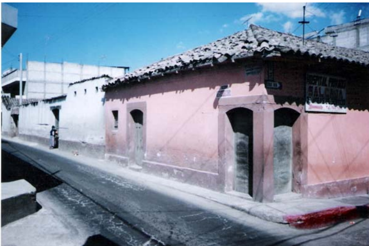
Foto # 12. 2 edificaciones de la fachada oeste aún originales a las cuales les falta mantenimiento. Fuente: Propia
