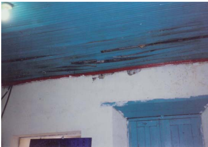
Foto # 33 Daños en el cielo suspendido del salón norte del edificio. Fuente: Propia.
