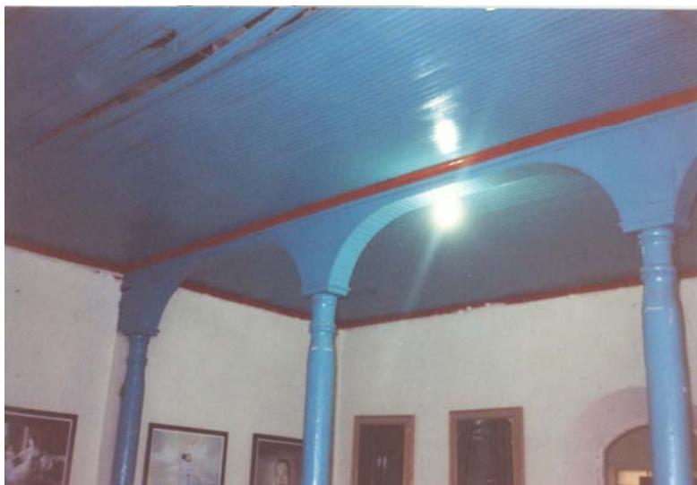
Foto # 34 Daños en el cielo suspendido del salón agregado al salón norte donde también se aprecia la añadidura entre la pared original y la adicional. Fuente: Propia.
