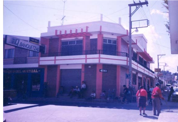
Foto # 18. Parte de la fachada este con edificación original demolida y re-edificada. Fuente: Propia
