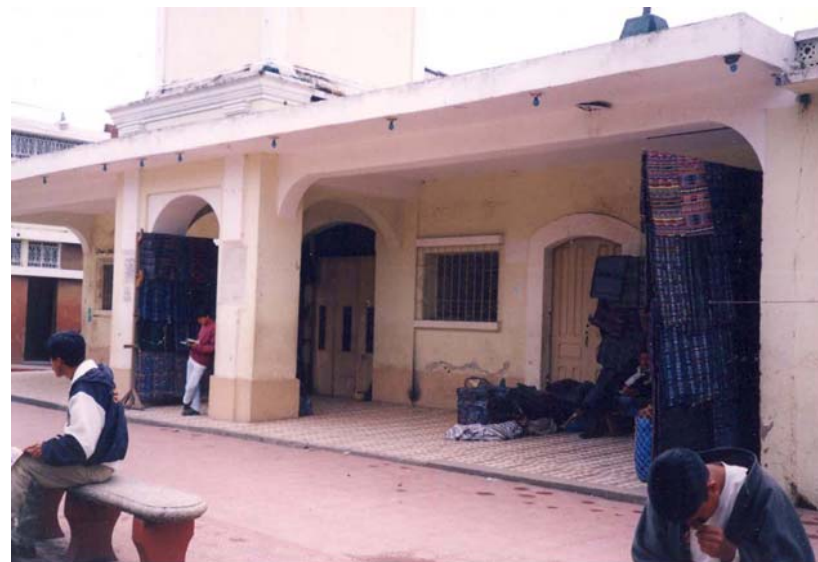
Vista de los pilares del frente del edificio en concreto Foto # 25. Fuente: Propia
