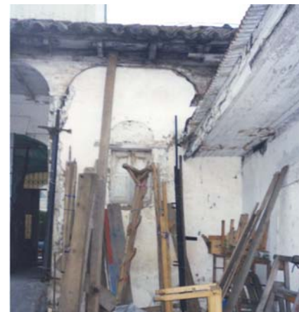
Foto # 36 Parte posterior del edificio donde se aprecian tapiados en lo que originalmente era un portal, se aprecian otros tapiados posteriores en la ventana, así como en la pared perpendicular, se advierte también la falla en la estructura en la parte de la esquina en donde colocaron un agregado para evitar el desplome del portal. Fuente: Propia
