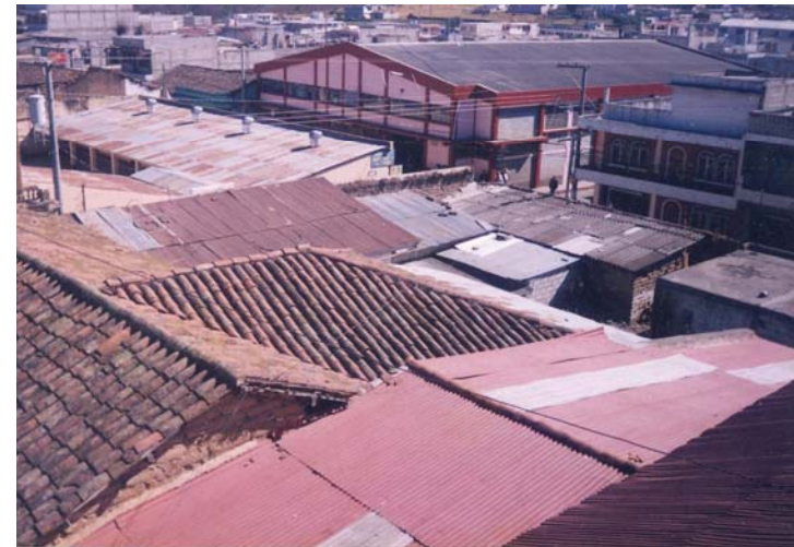
Foto # 28 Una vista de los techos del conjunto del edificio, nótese el estado de deterioro de la techumbre de los agregados ubicados en el patio trasero del edificio Fuente: Propia
