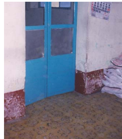
Foto # 35 Nótese el desgaste por uso en la pared posterior del salón agregado al salón norte, deterioro que se observa en la mayoría de paredes originales del edificio. Fuente: Propia.
