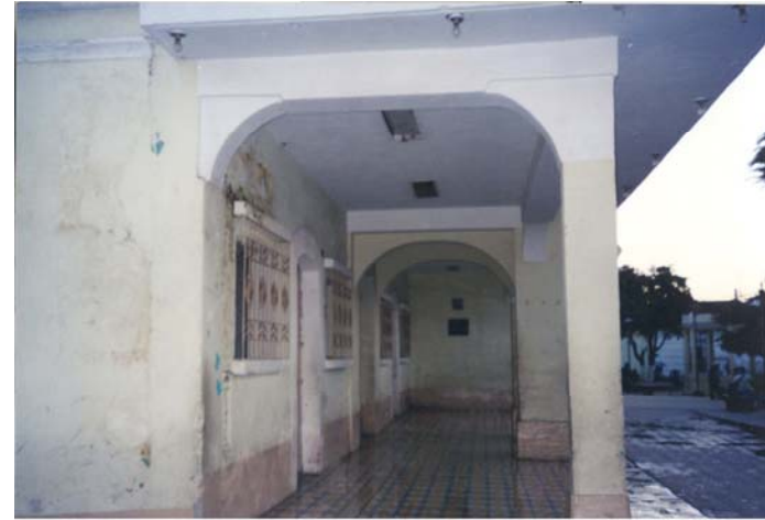
Foto # 27. Acercamiento por la esquina sur del corredor frontal con pabellón del edificio en donde se aprecian deterioros de acción prolongada, y del hombre. Fuente: Propia
