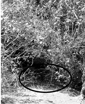
Foto No. 18 En la foto tomada en dirección de la base de la alcantarilla, se observa invasión de microflora, ocasionada por falta de mantenimiento.
