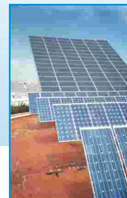
Paneles Solares. Fotografía:ATERSA
