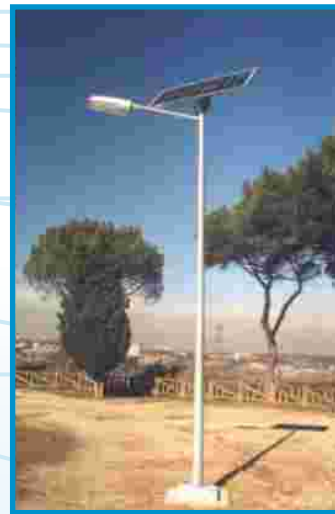
Iluminación pública. Fotografía:ATERSA
