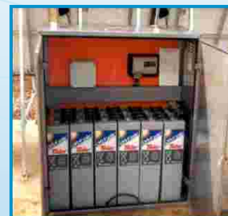
Baterías estacionarias. Fotografía:ATERSA
