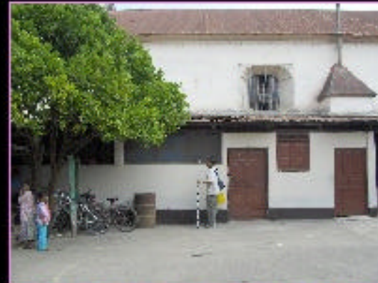
3. Fotografía en la que se observa uno de los vestros del templo, así como se aprecia la ubicación de otros entre las subestructuras adosadas y el Templo, así como los muros y vestros de maderas que poseen.
