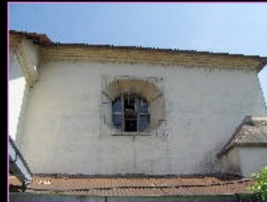
5. Fotografía del lado sur del templo, en el caso del presbiterio, se observa el estado de la zona de uno de sus frentes adosada al muro, así la fotografía se toma la verja del presbiterio y su contigüencia de esquina.
