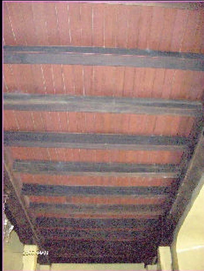
4) FOTOGRAFÍA DE ESTRUCTURA DEL MEZANINE DEL CORO ALTO, VISTA DESDE EL INGRESO PRINCIPAL DEL TEMPLO, TOMADA EL 9 DE ABRIL DEL 2005.
