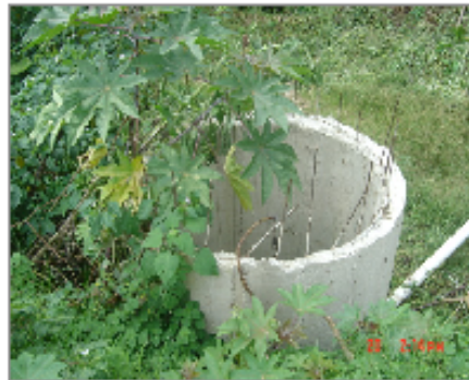
Foto #1: Pozo de concreto de 1.50 de diámetro x 1.00 de profundidad, el cual es el colector municipal para desfogar aguas de drenajes de proyectos del Mercado y SOM Municipal.
