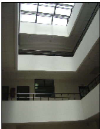
FOTO No. 1: DETALLE DE PISO DE LUZ CENTRAL EN EDIFICIO MUNICIPAL.
