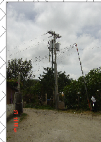
Foto #4: Poste generador de energía eléctrica de EEGSA, ubicado en la entrada al pueblo del Mercado Municipal. Este poste por su energía en forma trifásica para distribución del proyecto.
