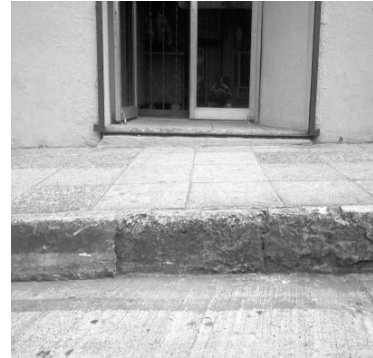
Fotografía No. 46. Al ingreso del Comité ProCiegos y Sordos no existe una sola rampa para acceso o salida. Fuente: propia, 2005.
