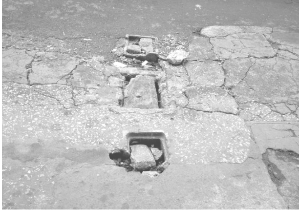
Fotografía No. 32. Deterioro en tapaderas de caja de agua en mal estado, 9ª. calle entre 3ª. Y 4ª. av. Zona I. Fuente: propia, 2005.
