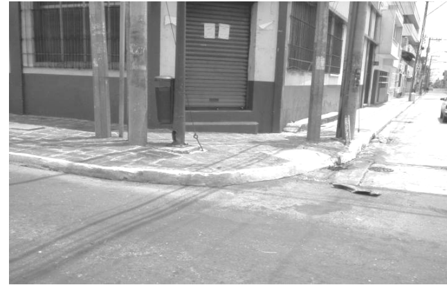
Fotografía No. 38. En esta esquina de la 8ª calle y 3ª avenida, zona I no sólo existe el problema común de bordillo de 0.19 cm. de altura sino la dificultad de fluidez peatonal debido a la cantidad de postes que se concentran en ella. Fuente: Propia, 2005.
