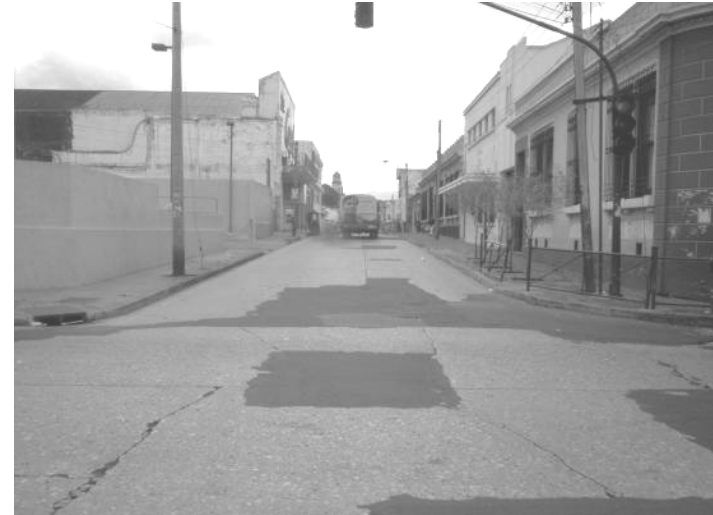
Fotografía 42. Esquinas hacia al anillo periférico, 8ª calle oeste y 4ª avenida, zona I. Fuente: Propia, 2005.
