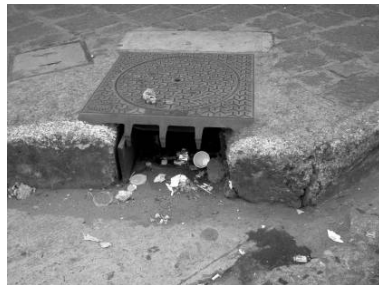
Fotografía No. 49. Drenajes con entrada de aguas pluviales peligrosas debido a la separación de sus rejillas. Fuente: propia, 2005.
