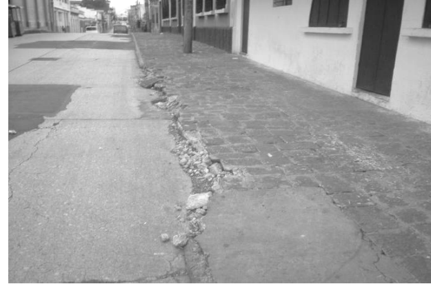
Fotografía No. 34. Banquetas recientemente construidas en mal estado por falta de mantenimiento, ancho 2.91 metros, 8ª calle entre 3ª y 4ª avenida, zona I. Fuente: Propia, 2005.
