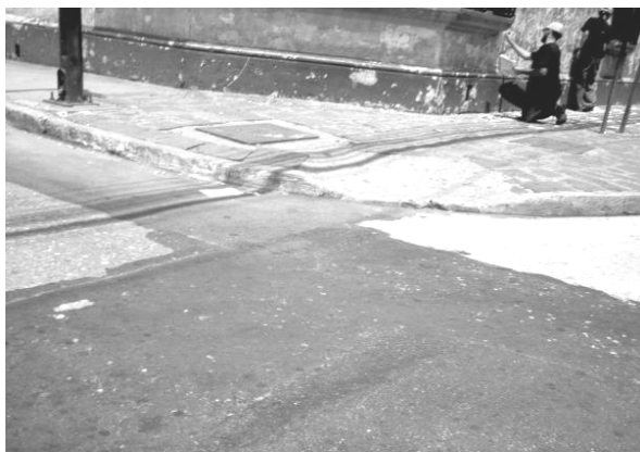
Fotografía No. 25. Esquina de bordillo con altura de 0.15 cm. Con una rampa muy pequeña no apta para personas con discapacidad. Ubicada en 9ª calle y 4ª ave, zona I. Fuente: Propia, 2005.
