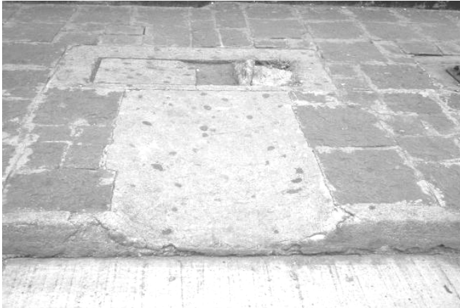
Fotografía No. 36. Diseño de rampas sin estudio arquitectónico, ya que por antropometría las dimensiones no son aptas para personas que utilizan silla de ruedas o aparatos especiales para su desplazamiento. Fuente: propia, 2005.
