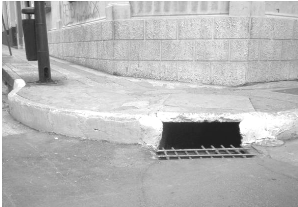
Fotografía No. 37. En todo el Centro Histórico suceden los mismos inconvenientes en altura de banquetas como esta de 0.31 cm. de alto ubicada en 8ª calle y 3ª avenida, zona I, además el peligro que representa el tamaño del tragante. Fuente: Propia, 2005.
