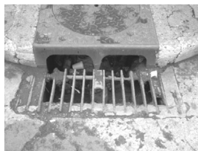
Fotografía No. 30. Tragante de tapadera cuadrada de metal rejilla de vanillas de acero fundido para evitar basura. Ubicada en la 4ª. Av. Y 8ª. Calle, zona I. Fuente: Propia, 2005.
