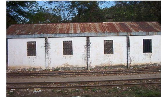
Foto No. 87 Daños de Ventanas y Columnas de la Bodega.
