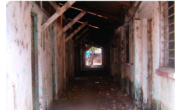
Foto No. 90 Daños en el interior de Viviendas 1 y 2.
