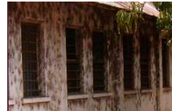
Foto No. 91 Daños de Muros y Ventanas en las Viviendas 1 y 2.
