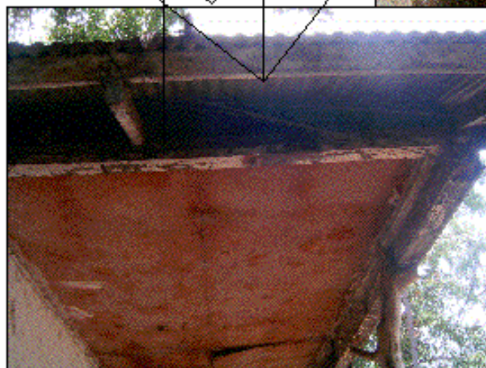
Foto No. G4. Vista de la estructura del techo de la vivienda C, se puede apreciar como la madera se ha ido deteriorando con el tiempo y por la falta de mantenimiento.
