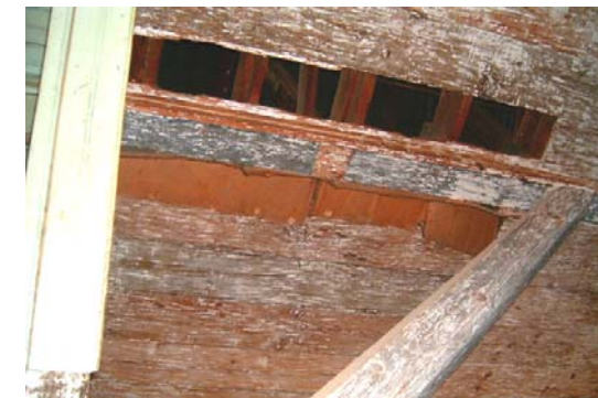
Foto No. 86 Daños del Machimbre.
