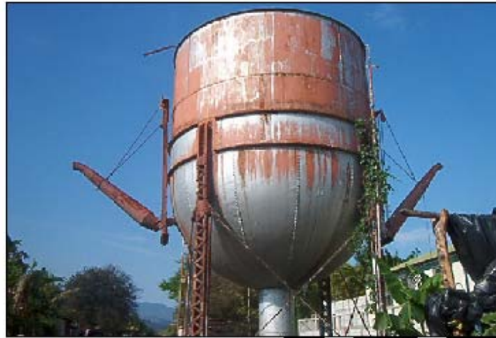
Foto No.36. Tanque de Agua. Aún funciona a pesar de su mal estado, sin embargo es importante repararlo puesto que aún sirve a la estación.
