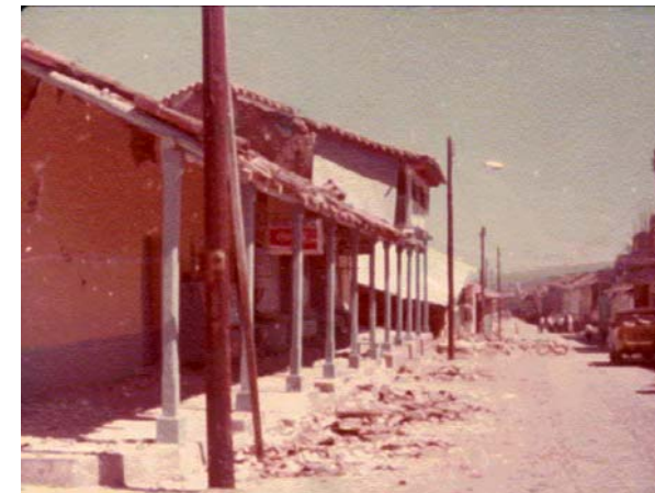
Foto No. 13. Portal después del terremoto. 73
