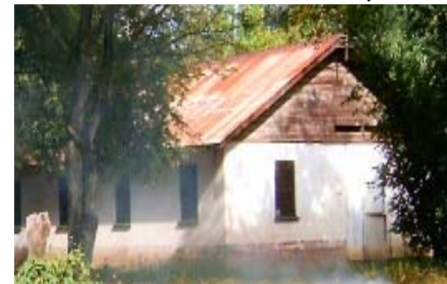
Foto No. 92 Daños de la Vivienda 3.
