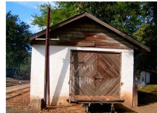
Foto No. 88 Daño del Ingreso de Bodega.
