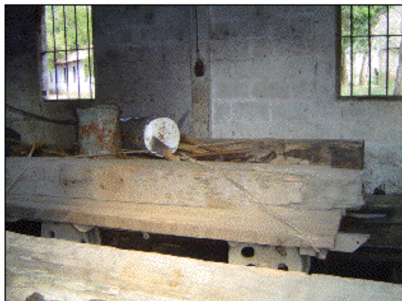
Foto No. 50. El área que se observa en esta fotografía es el interior de la bodega de mantenimiento en la cual se observa que habitualmente se encuentra en abandono y sirviendo como bodega.
