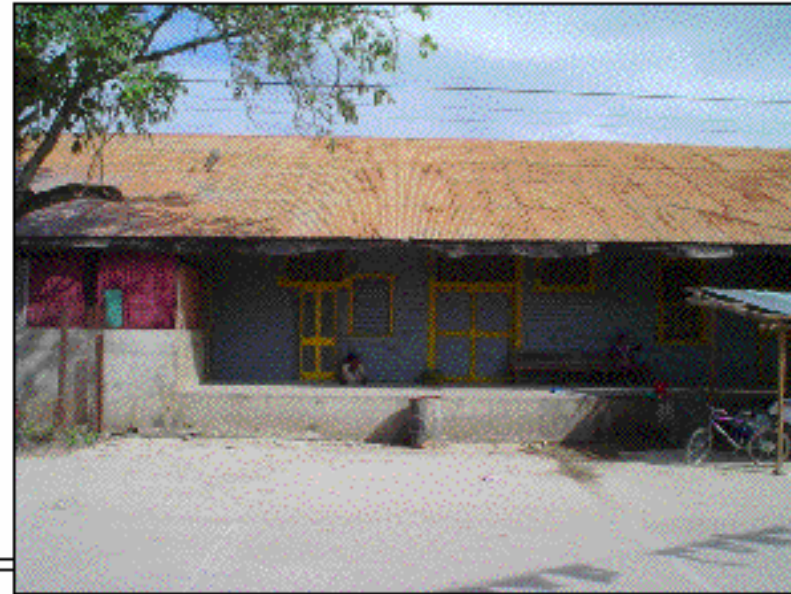
Foto No. 45. Elevación Frontal. Se puede observar el mal estado en que se encuentra la estación y como se ha perdido su función original.
