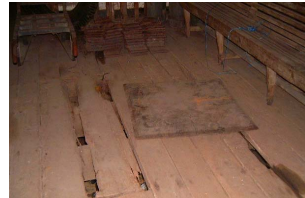
Foto No. 85 Daño de la Duela.
