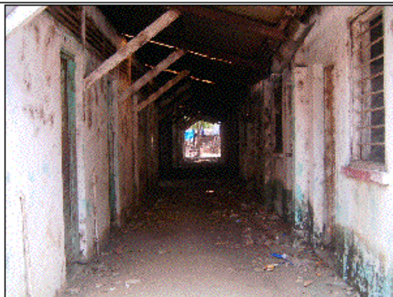
Foto No. 52. La fotografía muestra el estado de deterioro en que se encuentran algunas de las viviendas del conjunto, podemos observar la estructura del techo que se venían de estar pasando, así como las puertas y el repello de la parte inferior de las paredes dañada.
