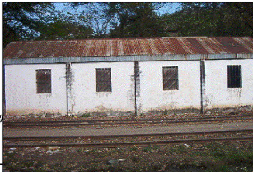
Foto No. 49. Esta fotografía muestra la elevación lateral izquierda en la cual se puede observar la presencia de hongos en la parte inferior del inmueble.
