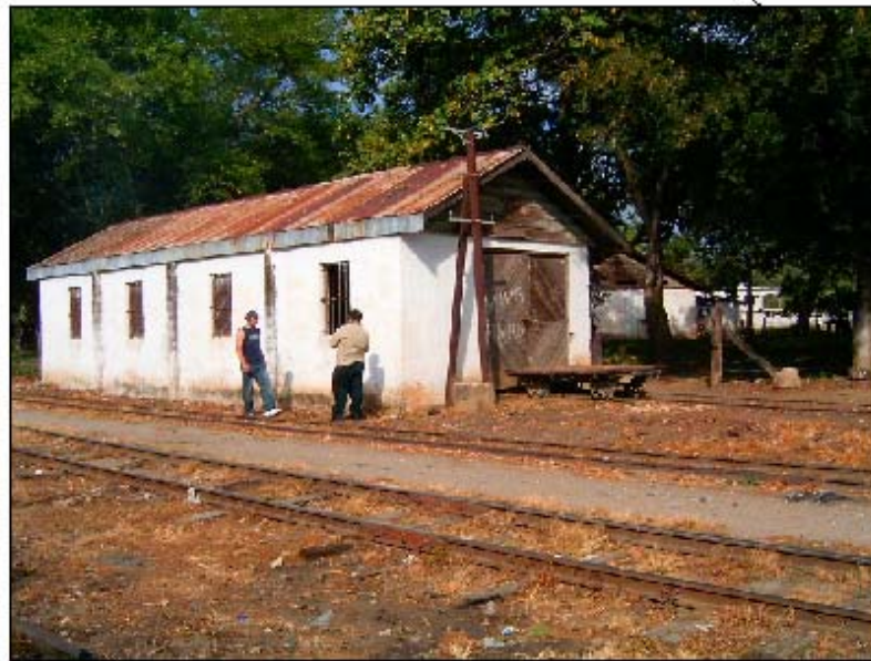
Foto No.38. Bodega de Mantenimiento. No funciona por su mal estado, por lo que los rieles e instrumentos para el mantenimiento de la línea se encuentran dentro del terreno, dañándose por la intemperie.
