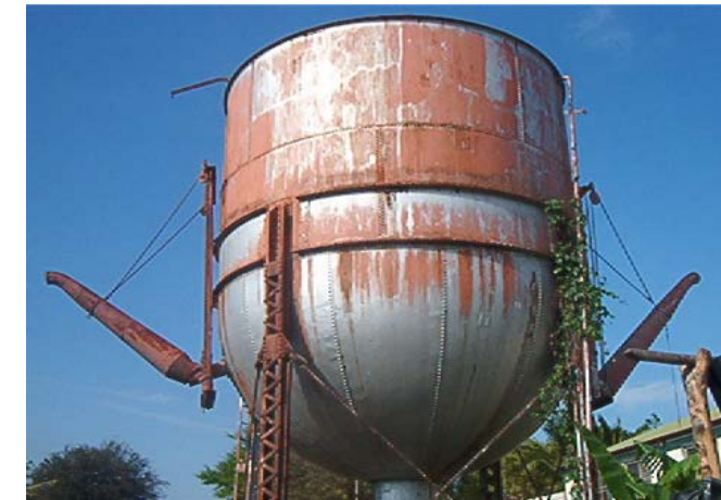
Foto No. 93 Daños del Tanque Elevado
