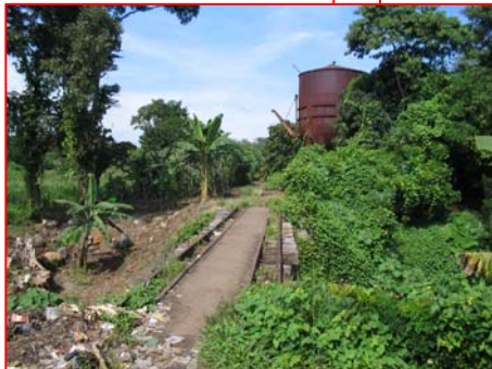
foto 34 inicio del polígono de la estación, el puente sobre el río Muluá que cuenta con una losa de concreto reforzado fundida al medio de los rieles.
