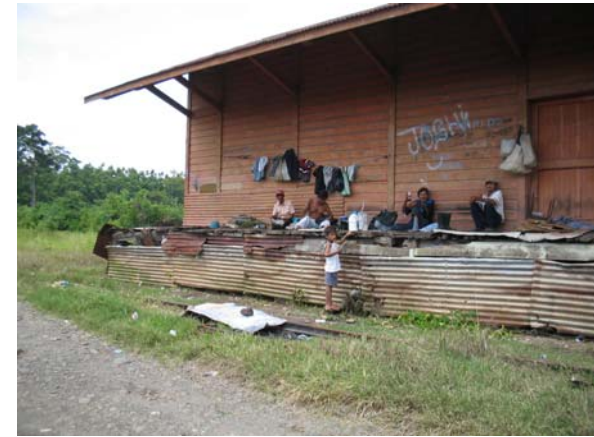
foto 6-24 Vista de la elevación sur del edificio principal de la estación, se observa la cubierta de lámina de zinc, y el forro con láminas en mal estado de la plataforma elevada de madera.
