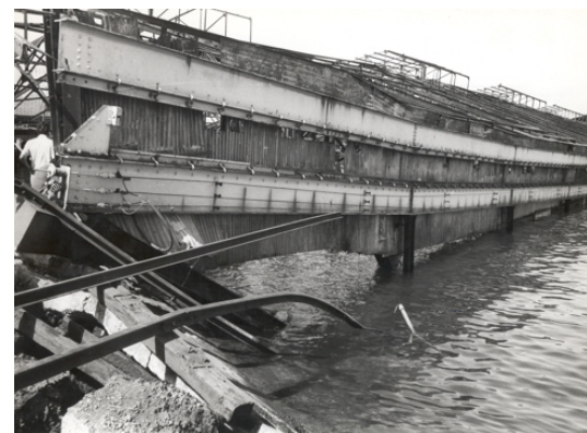
Foto 2-13. Daños a la estructura exterior del Muelle Puerto Barrios por sismo de 1976. Fuente : archivo FEGUA .
