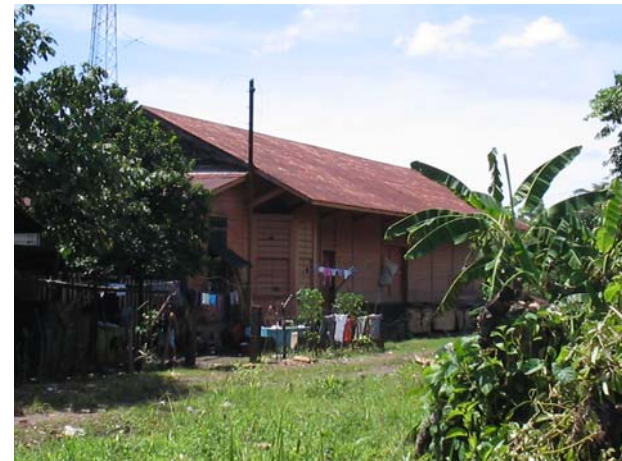
foto 6-25 en la elevación poniente se ubica adosada a la estación, dos ambientes que fueron construidos posteriormente para utilizarlos como dormitorios de paso.
