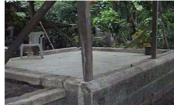
Fotografía 107 se aprecia la plataforma del que fue en su época fue el Hotel de la Estación Patulul, vista frontalmente (Edificio 2).
