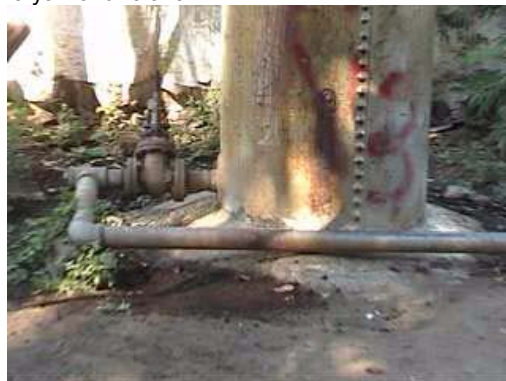
Fotografía 70 Se aprecia las conexiones de la conducción de agua potable de abastecimiento en el tanque de agua
