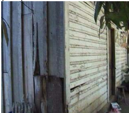
Fotografía 125 vista frontal y lateral del modulo habitacional del jefe de la cuadrilla sección 29
