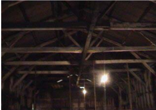
Fotografía 73, Instalación eléctrica del interior del edificio 1.
