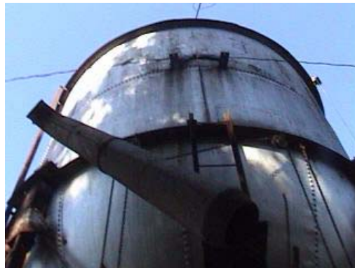
Fotografía 69 Se puede apreciar el estado en el que se encuentra dicho tanque, visto desde la parte de abajo.
