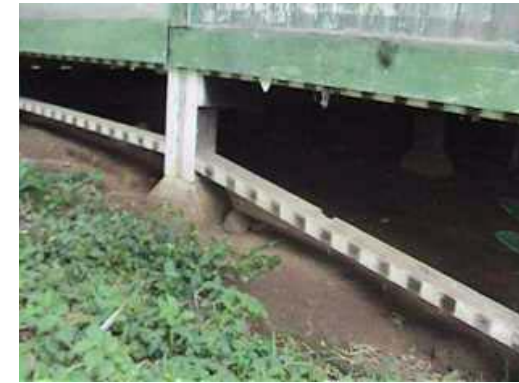
Fotografía 117 se observa el desprendimiento de cerramientos de la vivienda del telegrafista vista lateral izquierda (Edificio 3).
