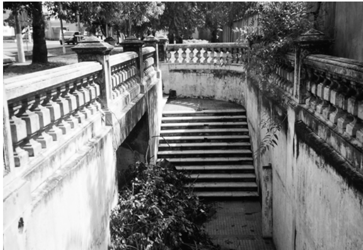
FOTOGRAFÍA No.55: OBSÉRVESE EL GRADO DE DETERIORO EN EL QUE SE ENCUENTRA EL TÚNEL. EL INGRESO TIENE BARRERAS COMO TRONCOS Y HOJAS PARA EVITAR EL INGRESO DE CUALQUIER PERSONA.
