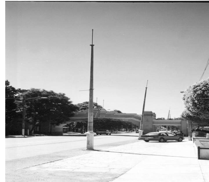
FOTOGRAFÍA No.51: EN PRIMER PLANO SE OBSERVA UN POSTE ORNAMENTAL BIEN CONSERVADO, EN SEGUNDO PLANO UN POSTE TOTALMENTE INCLINADO. POSTES UBICADOS FRENTE AL INSTITUTO ADOLFO V. HALL.
