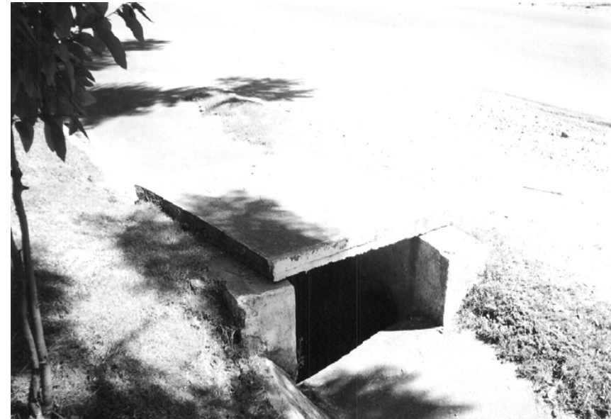
FOTOGRAFÍA No.65: SE PUEDE APRECIAR EL ESTADO EN QUE SE ENCUENTRA UN TRAGANTE DE AGUAS PLUVIALES.
