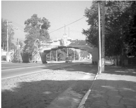
FOTOGRAFÍA No.64: SE APRECIA EN PRIMER PLANO LA CUNETAS QUE SE UBICA EN CIERTOS SECTORES DE LA AVENIDA DEL OBSERVATORIO. LA LONGITUD DE LA MISMA ES BASTANTE GRANDE APROXIMADAMENTE 0.75 MTS.
