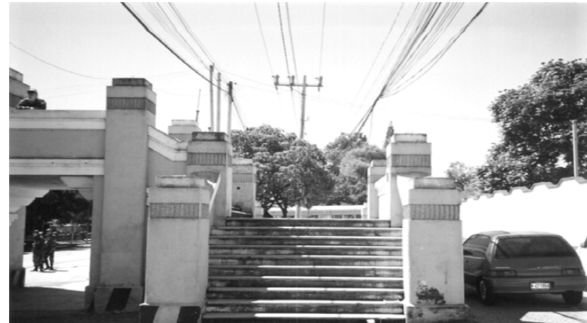
FOTOGRAFÍA No.60: LA CANTIDAD DE CABLES QUE PASAN ENCIMA DE LA PRIMERA PASARELA ES NUMEROSA. REALMENTE NO MUESTRA UN BUEN ASPECTO.
