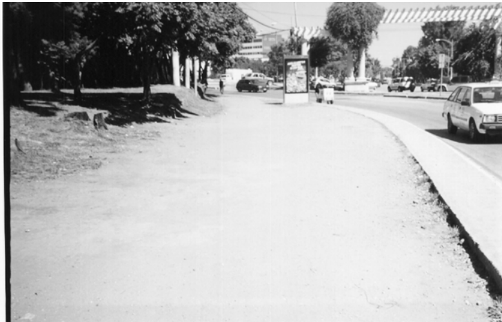
FOTOGRAFÍA No.50: OBSÉRVESE QUE GRAN PARTE DE LA ACERA ESTA CONFORMADA POR TIERRA, Y EL AREA DE CONCRETO ES BASTANTE PEQUEÑA.
