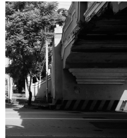
FOTOGRAFÍA No.54: VISTA DE OTRA PASARELLA, PRESENTA SERIOS DAÑOS EN SU PARTE INFERIOR. TAMBIÉN SE MUESTRA LA HUMEDAD QUE LA INVADE.
