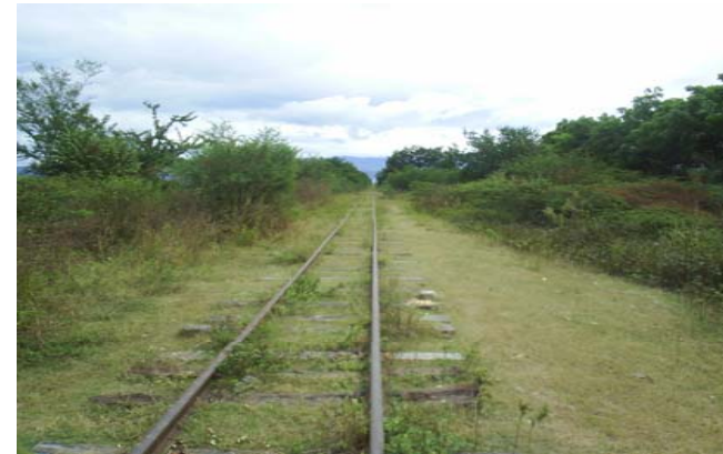
Foto No. 17 Invasión de vegetación a lo largo del tramo.
