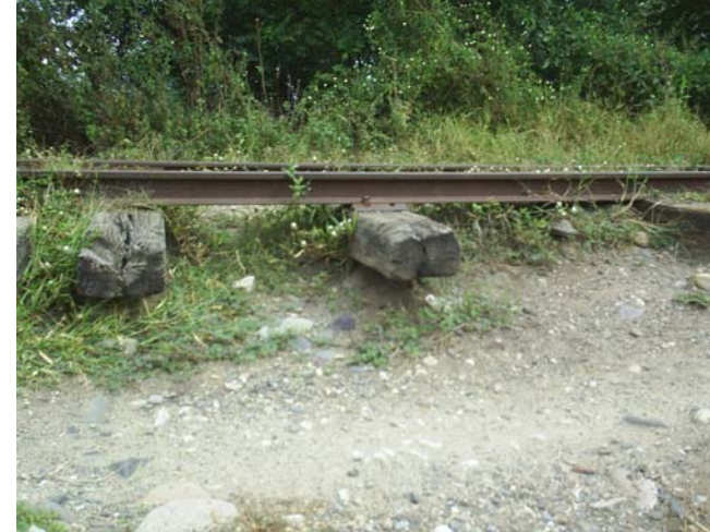
Foto No. 16 Pérdida de algunos durmientes a lo largo del tramo.
