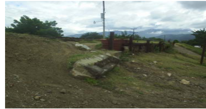
Foto No.14 Destrucción del terraplén.
