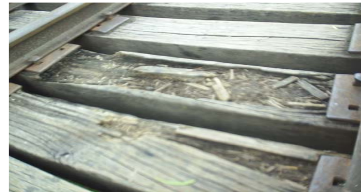
Foto No.15 Destrucción de madera de los durmientes.
