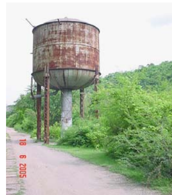
Fotografía No. 42 vista de tanque de agua estación el Chile.
