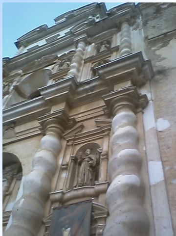
Fotografía No. 13, 14 Fachada y detalle de la Iglesia de San Francisco en Antigua Guatemala, en donde se observa que se utilizan varias de las operaciones de conservación, como liberación, reintegración, reposición y reparación.
