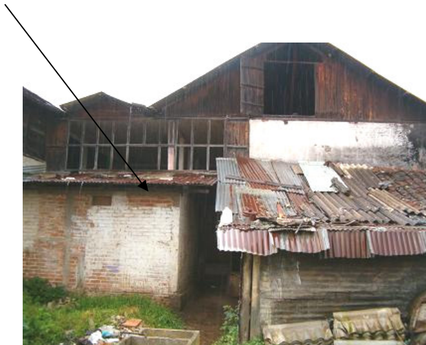
No. 4 SE PUEDE OBSERVAR EL DETERIORO EN LAS PARTES DEL EDIFICIO, QUE PONEN EN RIESGO LA VIDA DE LOS TRABAJADORES MUNICIPALES
