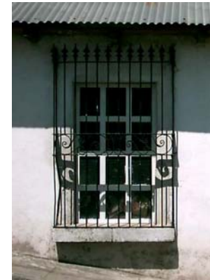
Fotografía No. 6.5 Ventana de madera + vidrio y sobre ventana Fuente: investigación propia
