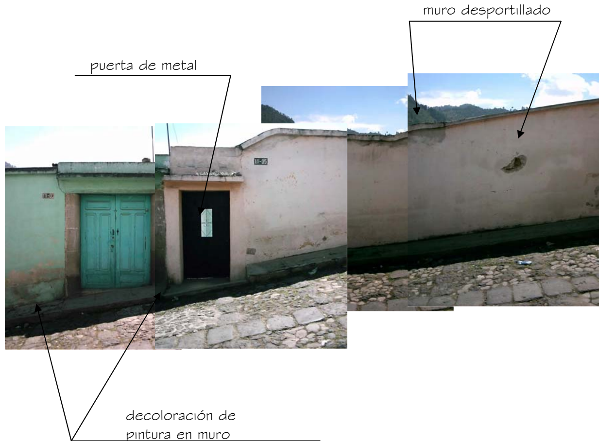
Detalle de muro desportillado y decoloración de pintura en muro.
