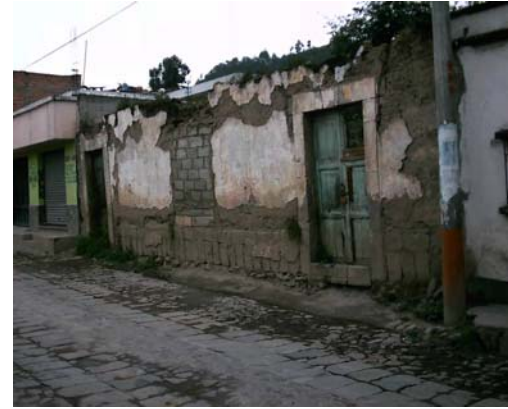
Fotografía No. 5.26 Vivienda abandonada. Fuente: investigación propia.
