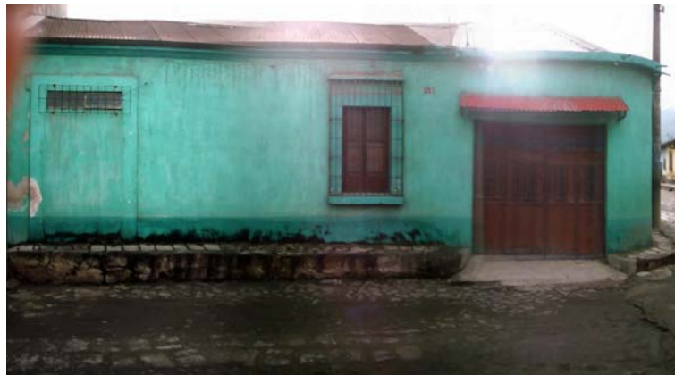
Fotografía No. 6.2 Fachada alterada por apertura de vano para ingreso vehicular. Fuente: investigación propia.
