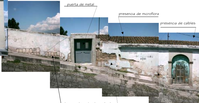
desprendimiento de acabados
