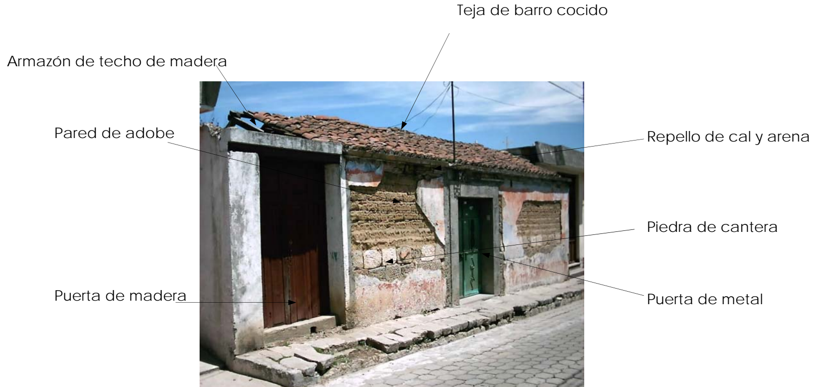
Fotografía No. 5.14 Se observa que los muros son de adobe, piedra de cantera, dos tipos de puertas de diferente material, madera y metal. Armazón de techo de madera y cubierta de teja. Fuente: investigación propia
