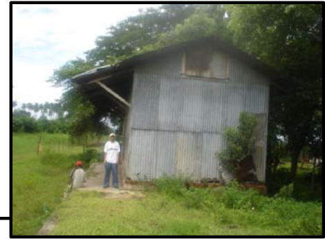
Foto 159 La fachada Norte muestra daños en la lámina como la corrosión y agentes naturales que dañan paulatinamente la estructura.
