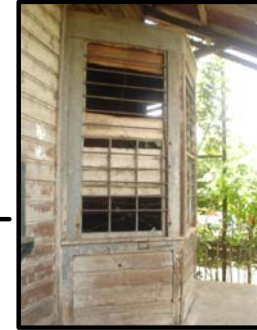
Foto 119 En la ventana de la oficina de la boletería se observa la falta de vidrios, corrosión en los balcones, las personas del lugar tienen tapados con tabla los espacios vacíos para evitar la entrada de lluvia y polvo sufriendo alteración la ventana.
