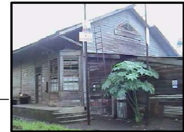
Foto - 93. Fachada norte, presentando daños en la ventana, provocado por agentes biológicos y naturales
