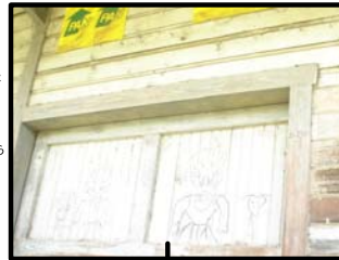
Foto 127 La puerta del lado este de la estación, se encuentra en buen estado a no ser del tapizado de los afiches políticos, y dibujos trazados por personas antisociales presentando deterioro en el inmueble.
