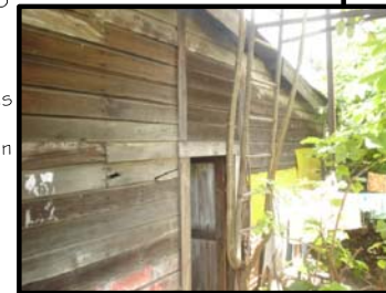
Foto 110 La puerta y la madera de la fachada exterior, ha sufrido daños provocados por la humedad y polilla, causando grietas y aberturas en la madera, el color original se fue degradando por los agentes climáticos.
