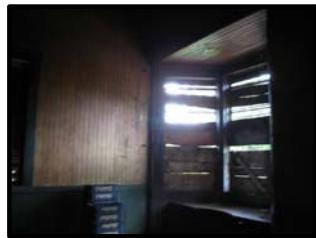
Foto 104. Ventana de Taquilla exterior presenta daños en su estructura, falta de vidrios, oxidación y pintura.
