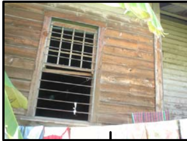
Foto 126 La ventana presenta daños en toda su estructura, ya no tiene vidrios, balcones de hierro oxidados, se encuentra muy deteriorado.
