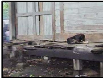
Foto 94. El ingreso del andén por las gradas se encuentra dañado por agentes climáticos y contaminación visual.
