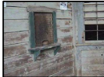
Foto 97. La ventana de la taquilla presenta daños de corrosión y pintura.
