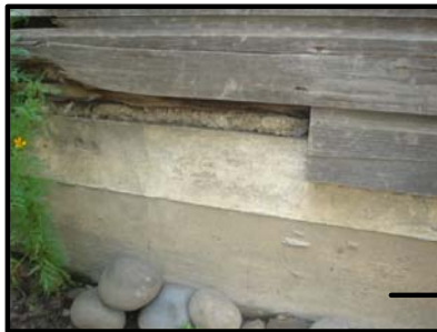
Foto 129 El cimiento corrido descubierto por la falta de piezas de madera provocado por la polilla y hongos ocasionado por la humedad de la lluvia
