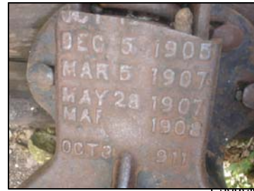
Foto 151 Base del Interruptor de desvío, con fechas memorables de mantenimiento.
