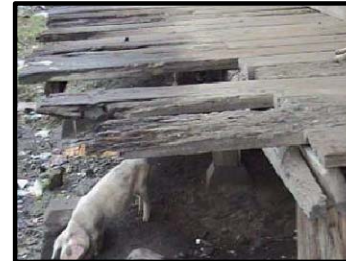
Foto 98. El andén principal se encuentra dañado por la polilla y contaminación visual.
