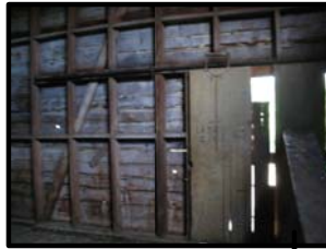
Foto 111 Los elementos verticales compuesto por parales de 2" x 4" se encuentra en buen estado, la madera de la paredes presentan daños por polilla y humedad, la puerta le faltan piezas de madera provocando la entrada de polvo lluvia a las instalaciones.
