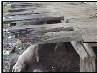
Foto 108 El deterioro del andén de abordaje es notorio, las piezas de madera están dañadas por la polilla, humedad, termitas, provocados por el abandono del edificio.
