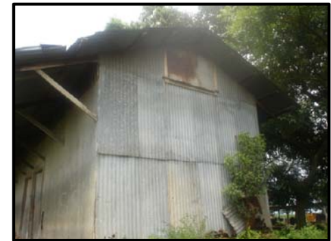
Foto 160 La mayor parte de la cubierta se encuentra oxidada y picada, además se encuentra en un alto grado de corrosión.
