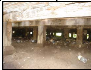
Foto 109 El cemento está compuesto por bases de concreto, y pilotes de madera, se encuentra dañado por el abandono del mismo, piezas deterioradas por hongos, humedad y termitas que han provocado daños en la madera.
