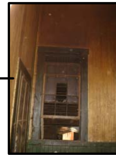
Foto 114 Ventana interior de la Boletería; se localizan algunos vidrios rotos, el marco y las paredes están en buen estado, manteniendo su color original.
