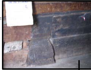
Foto 112 Un detalle especial del cemento son los pilotes de concreto para soportar los durmientes del edificio, se encuentra en buen estado, el forrado del cambio de nivel sí presenta daños, exponiendo el material del cemento de la bodega.
