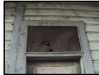
Foto 96. El sobremarco presenta daños en el cedazo provocados por el óxido.
