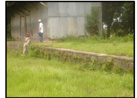
Foto 162 El andén de abordaje es de muro de piedra, se encuentra en buen estado, la piedra está pegada con mezcla, también se encuentra cubierto por la maleza debido al abandono.
