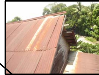
Foto 107 En la parte exterior del edificio, se puede observar el techo compuesto por lámina de zinc, oxidado y faltándole piezas de lámina levantados por el viento, presentando deterioro en la cubierta.
