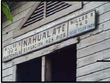
Foto 117 Los marcos de la ventana ya no los tiene, como el cedazo que tapaba los espacios vacíos está muy deteriorado, el rótulo y la ventana de la parte superior se encuentran en buen estado y se conserva.
