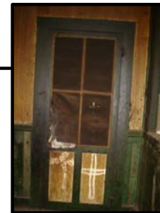
Foto 115 Puerta Interior de la Boletería, dañado con pintura de personas ajenas a la estación, el cedazo que tiene las vidrieras presentan fisuras en sus extremos; dañados por el mismo abandono que ha tenido la estación.
