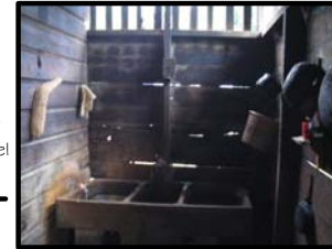
Foto 113 La lavandería se puede ver la celosilla de la ventana abandonada por las personas que pernoctan en la estación, también las paredes presentan fisuras, espacios abiertos porque le faltan piezas o están dañados por la polilla. Existe la pila y se le está dando uso en nuestros días.
