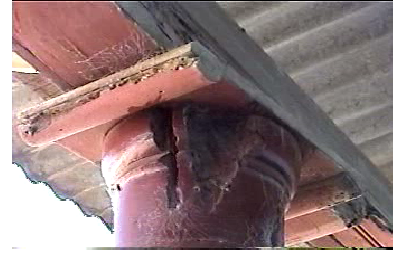
La presencia de insectos Xilófagos provoca el picado y deterioro de todas las piezas de madera, en la fotografía se observa el estado de la zapata de la pilastra del corredor (d).
