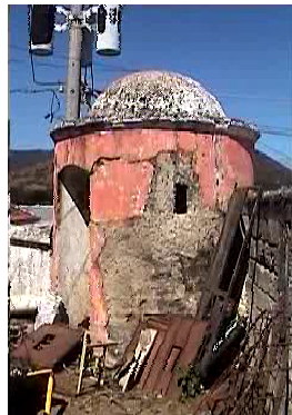
Torreón de extremo este de muro artillado, presenta un alto grado de deterioro y de alteración, ya que actualmente sirve de bodega.
