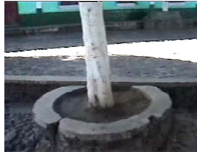
Las jardineras del área triangular presentan de sprendimiento de material.
