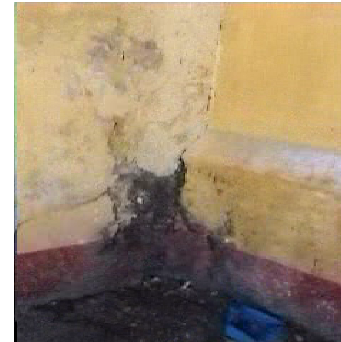
Desprendimiento de acabados y presencia de hongos y humedad, en gran parte del edificio.
