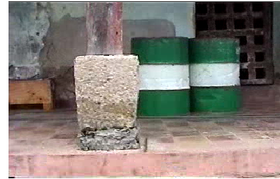
Desprendimiento de material en bases de las columnas del corredor interior (o) del edificio del ala norte - sur.
