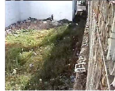
Existe un cambio de nivel de 4 mts. entre la plaza y la parroquia, el cual esta separado por el muro de contención.
