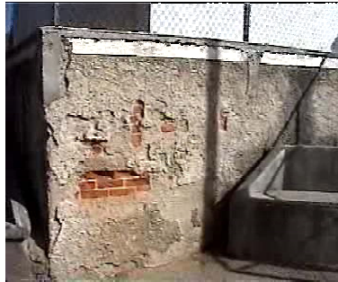
Estado actual del muro que divide la iglesia de la plaza pública.
