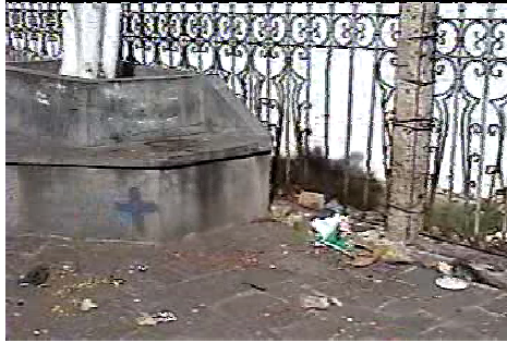
Se observa la falta de mantenimiento en la plaza y la oxidación de los elementos metálicos.
