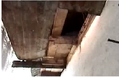
Deterioro del alero en cubierta de edificio ala este - oeste.
