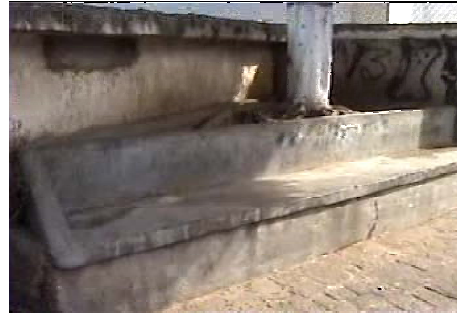
Las bancas presentan grietas, fisuras y desprendimiento, principalmente por la baja calidad constructiva de su estructura.
