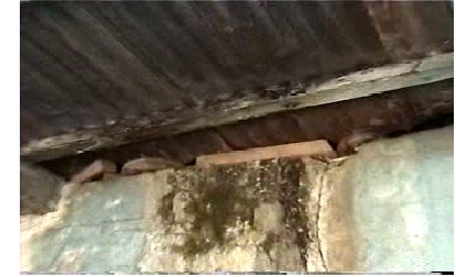
Deterioro de muros y techo de corredor (o) del edificio del ala este-oeste del Antiguo Cabildo.
