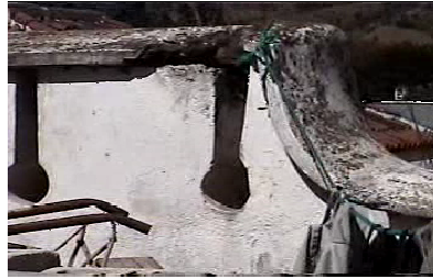
Situación actual de muro artillado, muestra desprendimiento de Material.
