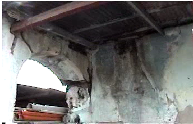
Arco de corredor (d) en la actualidad presenta agrietamiento y presencia de hongos.
