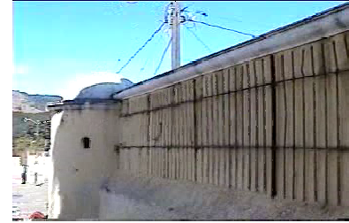
Estado actual del muro lateral oeste del Antiguo Cabildo, este presenta deterioro en sus acabados.
