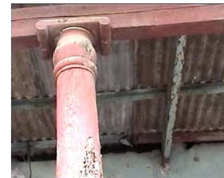
Fotografía No. 106 Detalle de capitel de las columnas del corredor principal (d), en éste se observa el tallado de la zapata. En la fotografía se puede distinguir el deterioro de la columnas, tendales, costaneras y cubierta.
