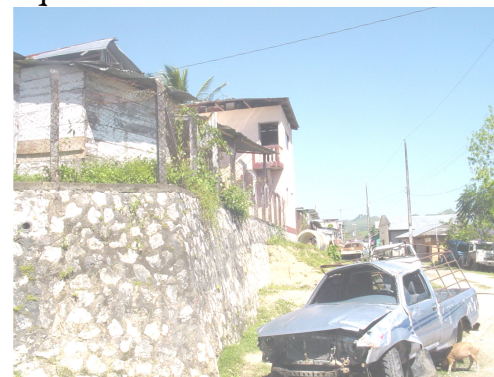
Foto No.6 Vista parte posterior del terreno, en esta foto se observa la diferencia de nivel que existe desde el pavimento de la plaza hasta esta calle. El muro de contención que se observa en la foto se encuentra abajo del nivel de la plaza 3,50 metros. Debido al desuso de esta parte del terreno lo han convertido en basurero y depósito de vehículos chocados.
