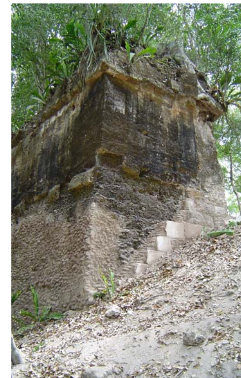
Vista de un muro de contención Edificio M, se consolido Nakum 2004. (Luis Guardado)
