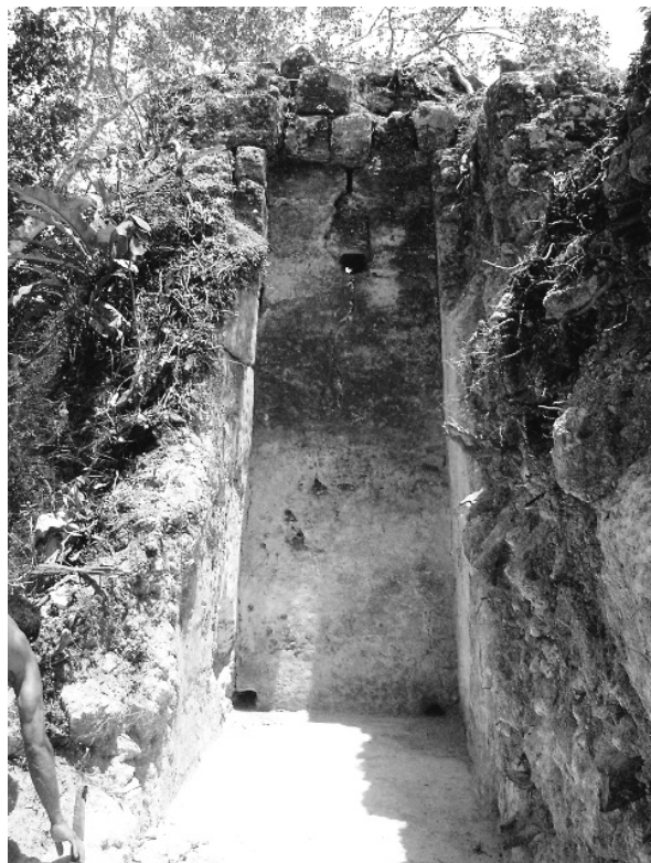
Fig. 33. Bóveda colapsada edificio C, se aprecia la conformación del muro Fachateado con un núcleo central y el arranque de la bóveda Nakum Peten. (Luis Guardado)
