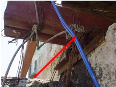
FOTO 7. Este es un anclaje estructural de la estructura que actualmente cubre el atrio de la municipalidad, como se muestra en la fotografía, se encuentra en estado de corrosión.
