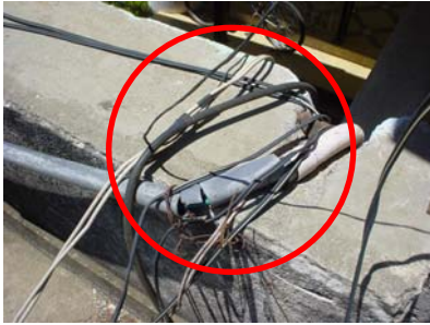
FOTO 6. El mal estado de las instalaciones eléctricas, constituye también un riesgo para las personas que laboran en el edificio que actualmente ocupa la municipalidad.
