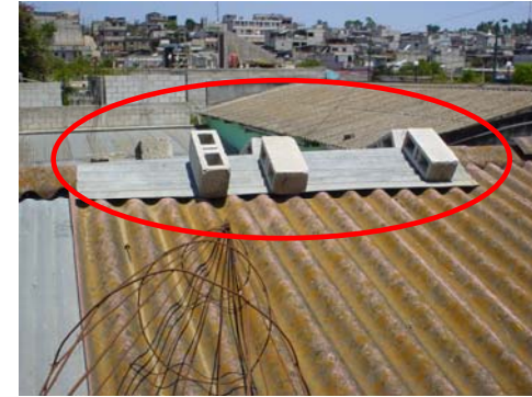
FOTO 4. El estado actual del techo provoca filtraciones de agua, que no permiten realizar las actividades municipales adecuadamente.
