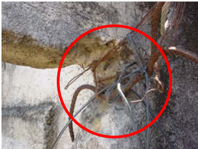
FOTO 8. Esta es una de las columnas que soportan el peso de la estructura de la cubierta final, y como puede observarse se encuentra en muy mal estado.
