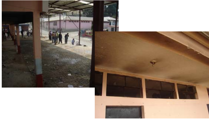
FOTO 34 y 35: Daños ocasionados al inmueble municipal.
