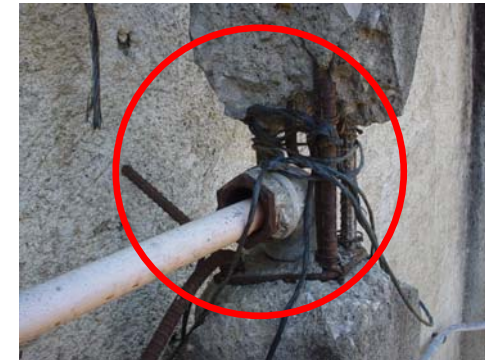
FOTO 5. El daño en una de las columnas del edificio, así como el paso de una tubería de instalación por la misma, demuestra el estado del sistema estructural del edificio.
