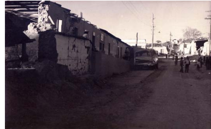
FOTO 1. Así se encontraba el edificio municipal a finales de 1976, luego del terremoto que azotó a la república de Guatemala.
