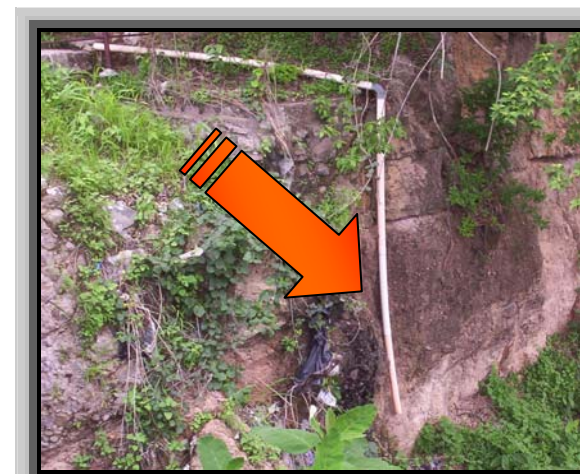
FOTOGRAFÍA No.24. Aquí se muestra la vía secundaria y las condiciones en que se encuentra.
