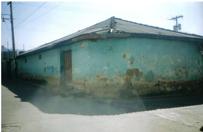
Foto VI: Deterioro en los muros y cubierta, desprendimiento de acabado, humedad, destrucción de la banqueta, lamina en mal estado, cielo falso en el alero deteriorado.
