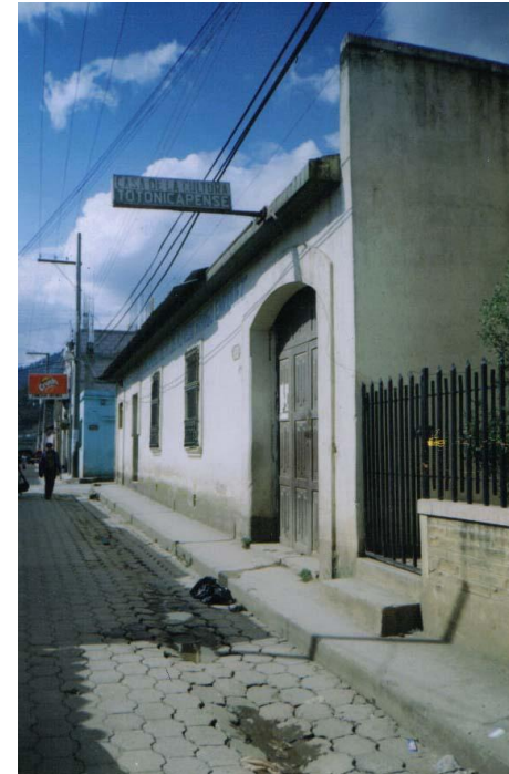
Foto II: Vista de la Fachada sur, rotulo en mal estado, portón de madera deteriorado por humedad, verja de metal oxidada, banqueta en mal estado.
