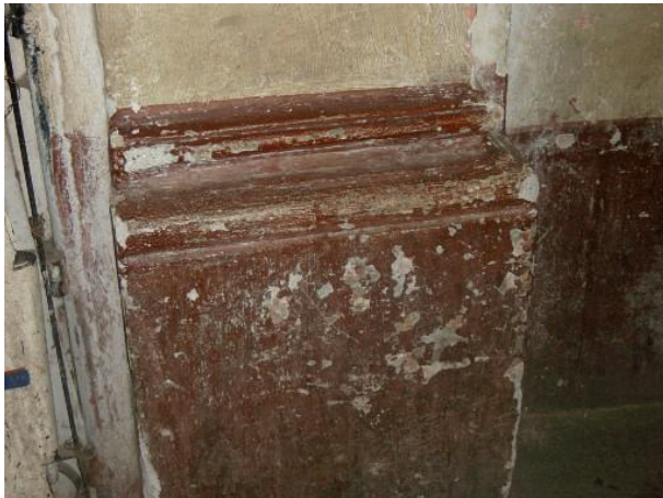
Foto XIV: Se observa el detalle de la base del arco del zaguán, esta deteriorado y tiene una capa de pintura de aceite.
