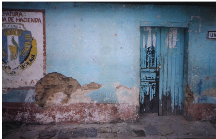
Foto X: rotulo en pared, puerta deteriorada, muros con desprendimientos de acabado, humedad en muros, banqueta en mal estado.
