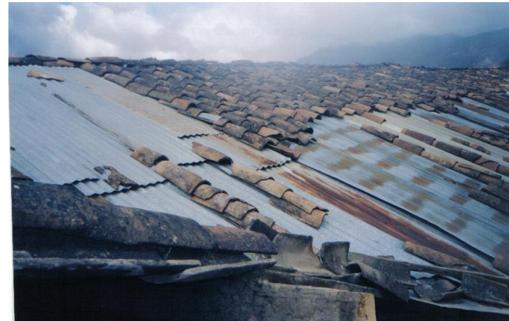
Foto XXVIII: vista del estado actual de la cubierta, la mayoría esta cubierto con lamina de zinc, algunas áreas con teja de barro, siempre sobre puestos sobre la lamina de zinc.
