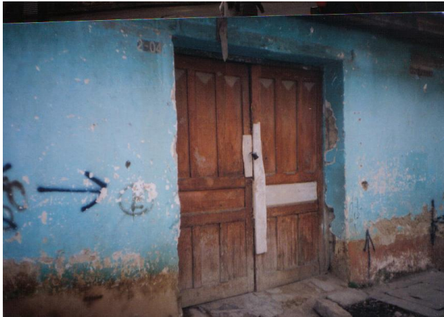
Foto VIII: puerta de madera en mal estado, muros con humedad, desprendimiento de acabados, rotulos en paredes.
