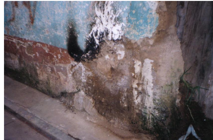
Foto V: humedad, desprendimiento de acabado, erosión, muro en constante deterioro.
