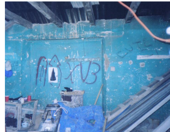
Foto XXX Puerta tapiada, acabado en muros en mal estado, grafitti
