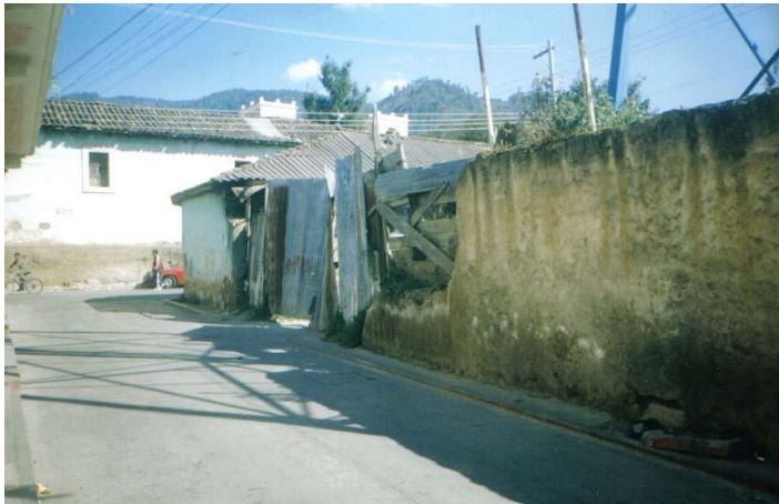
Foto IV: Vista de la fachada este donde se observa el deterioro del muro perimetral de adobe, una parte del cerramiento improvisada con lamina y madera.
