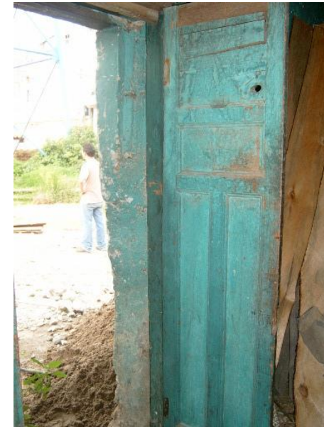
Foto XXVI: Vista del marco de puerta en mal estado, humedad, desportillado, además del deterioro de la puerta.
