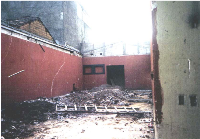
Foto XV: Salón de Usos Múltiples, a pesar de ser una construcción nueva relativamente, su estado es de total abandono y deterioro, ya no tiene techo lo que deja a la intemperie este espacio, causando humedad a las paredes y desprendimiento del acabado.
