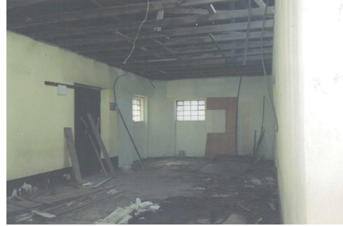
Foto XVI: se observa interior del ambiente donde se ubicaba la biblioteca, en abandono, no tiene cielo falso, instalaciones eléctricas expuestas, armazón del techo en franco deterioro, ventanas de metal con los vidrios rotos, puertas tapiadas.
