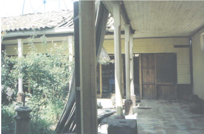
Foto XII: Vista del corredor interior, aunque se mantiene el cielo falso ya esta deteriorado, el piso es de granito no siendo el original, en la cubierta se observa que una parte ya no tiene teja de barro, el canal se ha caído, la vegetación esta descuidada lo que ha permitido su crecimiento descontrolado, a las columnas y sus bases se les ha aplicado pintura de aceite, además de que algunas ya están deterioradas, al fondo se puede observar un entrepaño de madera en mal estado.
