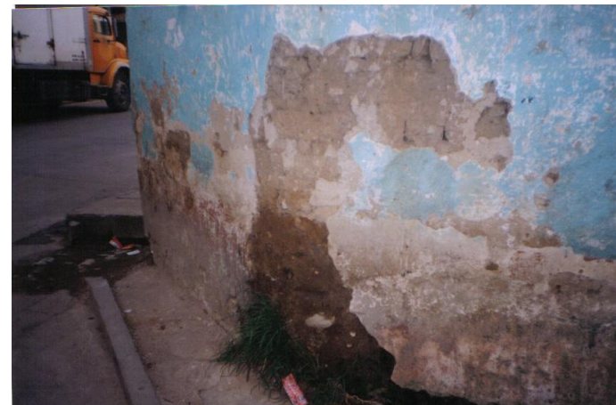
Foto VII: deterioro por humedad, desprendimiento de acabado, sin banqueta, vegetación.
