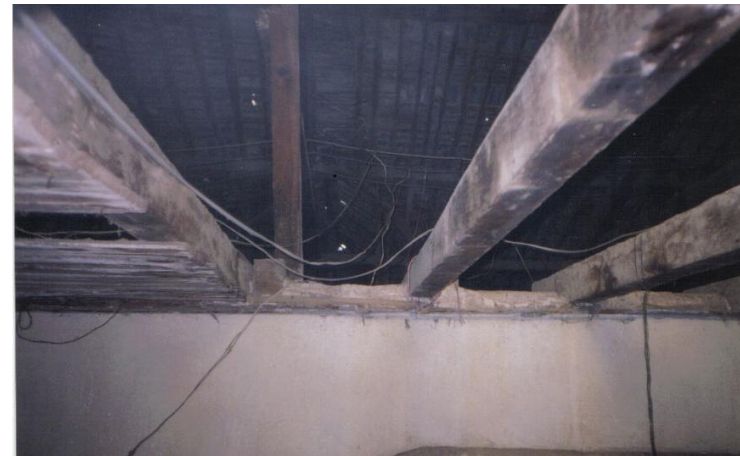
Foto XVIII: vista de la estructura de techo, no cuenta con cielo falso, las instalaciones eléctrica están expuestas, los tendales deteriorados.
