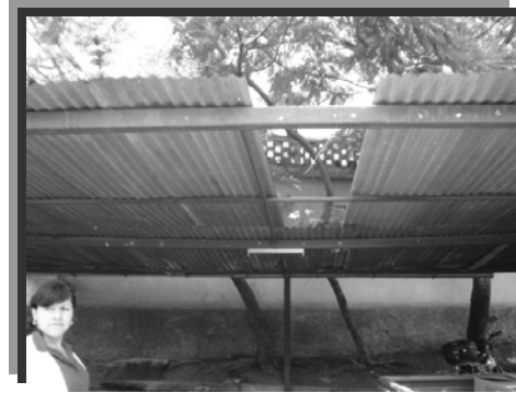
Fotografía No.7 Vista de la cubierta del parqueo, la cual se encuentra en mal estado.
