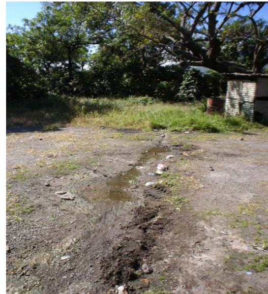
Fotografía No. 30 Se encuentra esta zona con un drenaje a flor de tierra, provocada por la saturación de agua en el suelo.
