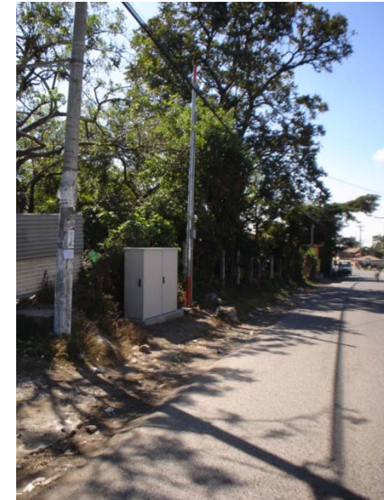
Fotografía No.23 En la vía principal se encuentran todos los servicios básicos, se observa un tablero de distribución de líneas telefónicas.
