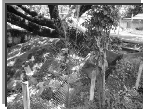
Fotografía No.9 Desembocadura de drenajes de aguas negras al río, a unos dos metros del predio del centro, el cual no posee muro perimetral, solamente malla.
