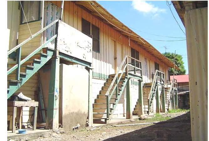
Fotografía No. 57. Vivienda multifamiliar denominada “Yarda”, finca Chicasaw, distrito de Motagua, Los Amates, Izabal. Fuente: visita de campo.
