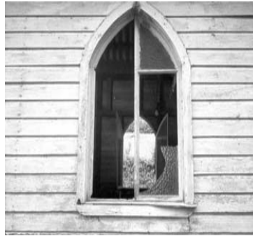
Vista exterior de deterioro de ventana lateral. (M. Alonzo) .
