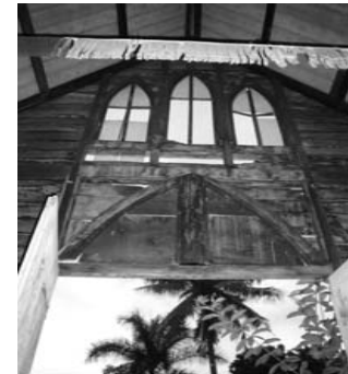
Vista interior de deterioro de ventanas y puerta. (M. Alonzo).
