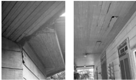
Deterioro de techo comedor (M. Alonzo).
