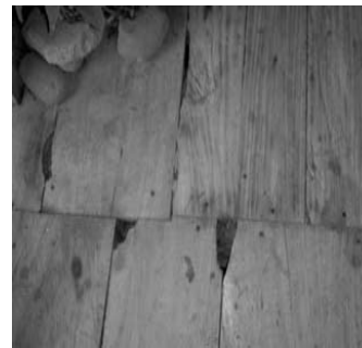
Detalle de deterioro en pisos. (M. Alonzo).
