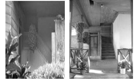
Detalles de deterioros en gradas segundo nivel. (M. Alonzo).
