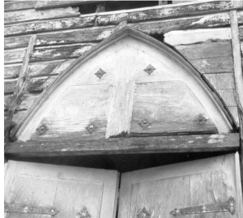
Detalle de deterioro puerta parte superior. (M. Alonzo).
