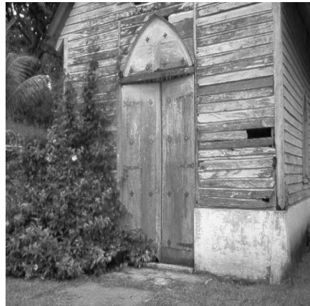
Vista de deterioro de la puerta principal. (M. Alonzo).
