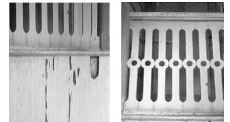
Detalle de deterioro de barandal en gradas. (M. Alonzo).
