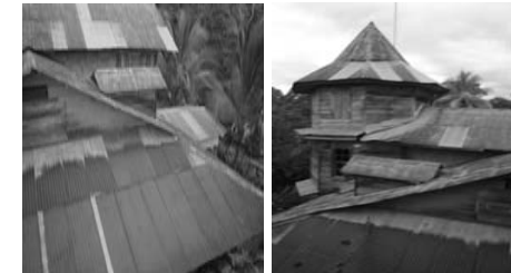
Vista de deterioro del techo. (M. Alonzo).
