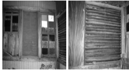
Detalle de deterioro ventanería interior. (M. Alonzo).
