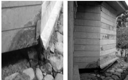
Detalle de humedad en paredes del comedor. (M. Alonzo).
