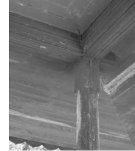
Detalle de deterioro en vigas, columnas y techo. (M. Alonzo).
