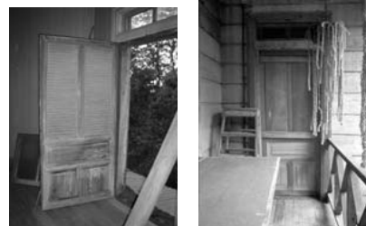
Detalle de deterioro en puertas exteriores. (M. Alonzo).
