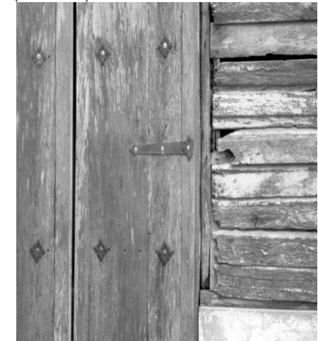
Vista de deterioro puerta y muro. (M. Alonzo).
