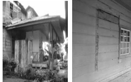
Deterioro en paredes. (M. Alonzo).
