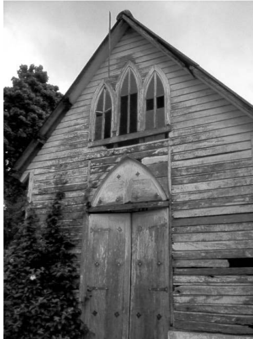
Detalle de la puerta principal y ventanas en fachada frontal Iglesia Católica. RNP Buenos Aires. (M. Alonzo).
