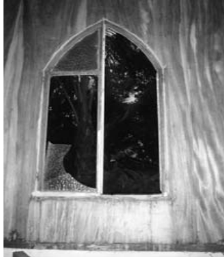
Vista interior de deterioro de ventana lateral. (M. Alonzo).
