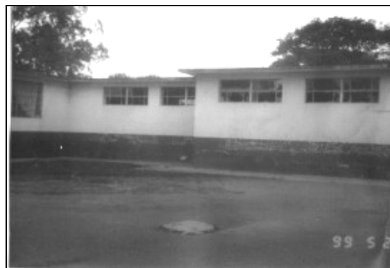
41 Existe un 5% de vidrios en buen estado en una de las 8 aulas existentes..
