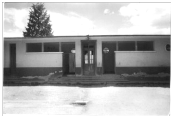
38 Se aprecia las puertas de ingreso a la batería de baños totalmente deterioradas, al igual que las ventanearía.
