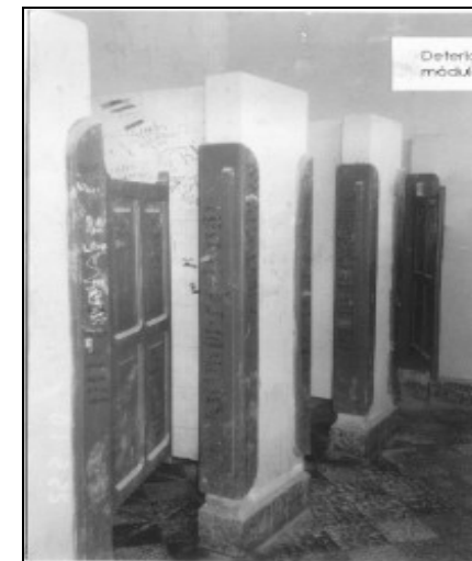
42 Deterioro y falta de mantenimiento de los módulos de servicio.
