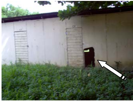
FOTO 26. MURO DE LA COCINA QUE DA HACIA LA YARDA.
