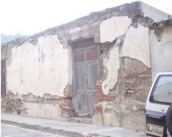
Mampostería colonial, de casa antigua y en deterioro. Fuente: Elaboración propia. Marzo 2005.
