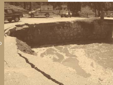
IMAGEN 3.2-1: Camino hacia caserío Las Cataratas afectado por el crecimiento del cauce del río debido a las fuertes lluvias.
