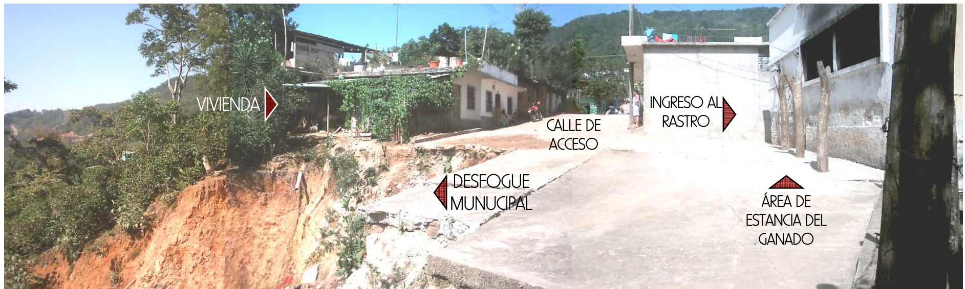
IMAGEN 13: Vista panorámica del deterioro de la calle de acceso, ocasionado por el desfogue municipal.
