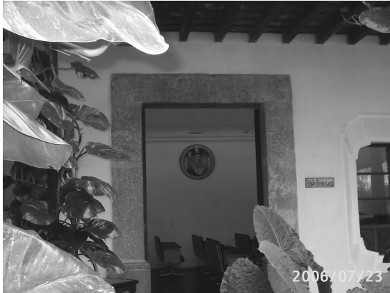
Fotografía 58. Detalle de jambas de piedra de la puerta de ingreso al Salón General Mayor.
