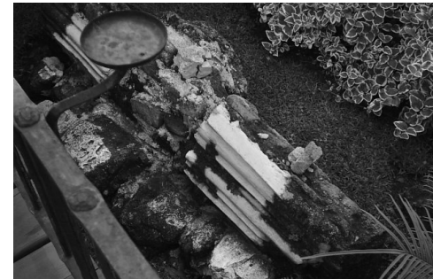
Fotografía 70. Escombros que formaban parte de los frisos que adornaban parte del edificio.
