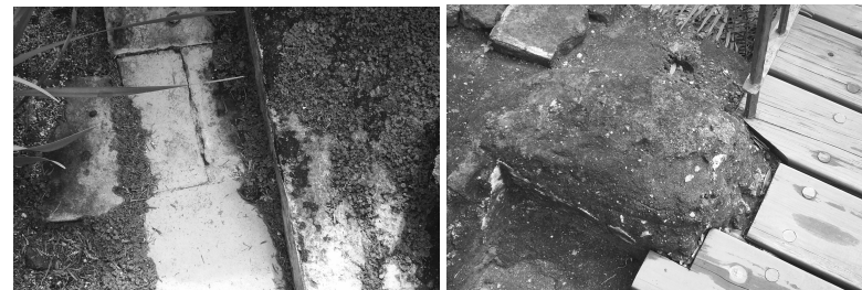
Fotografías no. 78 y 79. Se observa una pequeña área donde aun se conserva parte del piso original. El puente que comunica el paseo de los museos esta anclado a un muro acelerando el deterioro del mismo.
