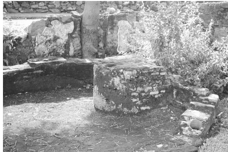
Fotografía 68. Crecimiento de vegetación y hongos por humedad en el área de la fuente.
