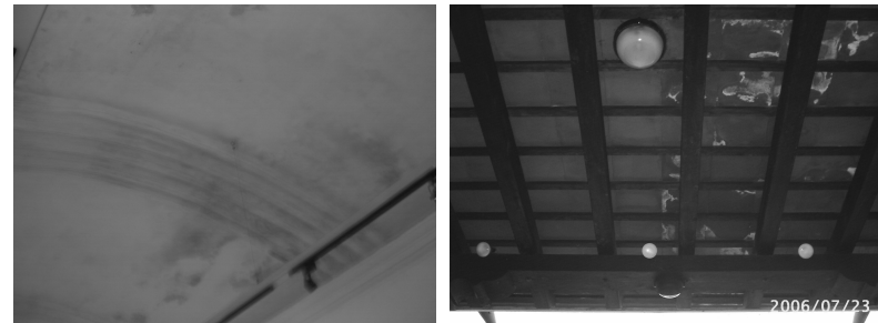
Fotografías no. 76 y 77. Bóveda de cañón corrido donde se observan las manchas de humedad y hongos, al igual que en los corredores en la baldosa de la terraza española.
