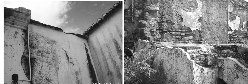
Fotografías no. 74 y 75. Se observa un muro con manchas debido a la humedad y los hongos. También se puede observar un muro que presenta disgregación de materiales entre otros daños.
