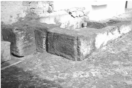
Fotografía 55. En el área del patio junto al albergue y la cocina, se localizan muros en ruinas, los cuales se cree eran parte de aulas, aun se observan los cimientos y parte de los muros de las mismas.
