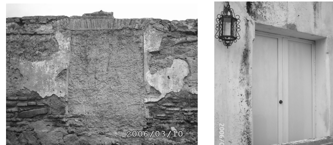
Fotografía no. 82 y 83. Vano de una ventana que daba al atrio, hoy Escuela Luis Mena, esta tapiada con block. En el caso de la puerta de la cocina esta contrasta con el conjunto.
