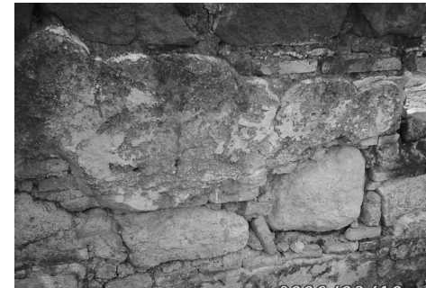
Fotografía 69. Detalle de erosión en las juntas de muro.
