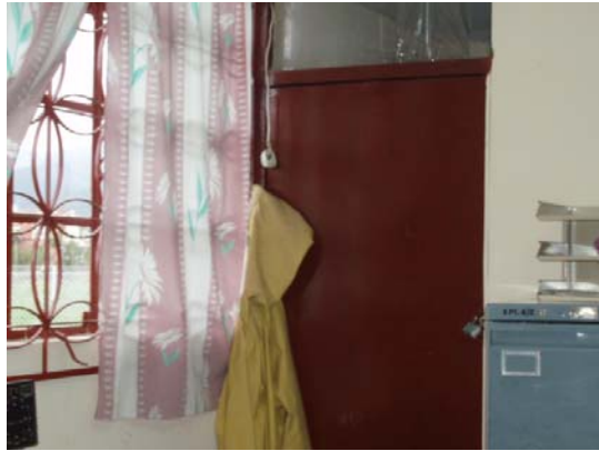
Se observa en los módulos más recientes Puertas y ventanas de metal + vidrio.
