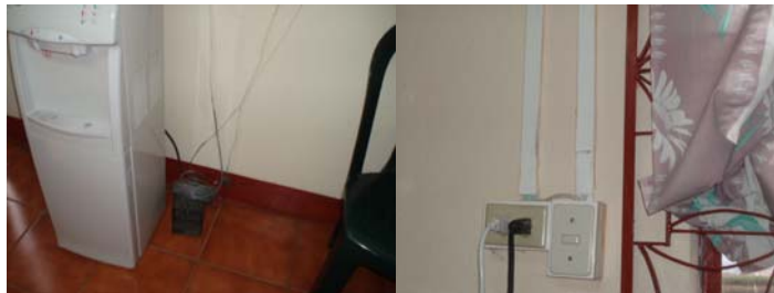
Ya que no se prevén las instalaciones eléctricas estas son expuestas.
