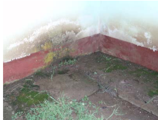
No se instalaron canaletas por lo que los muros presentan hongos en la parte inferior.
