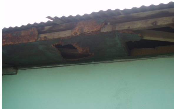
Se colocó cielo falso de machimbre y plywood, debido a las condiciones de la lámina, este se encuentra deteriorado en su totalidad.
