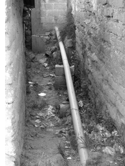
FOTO No. 48. CONTAMINACIÓN POR BASURA Y DRENAJE SUPERFICIAL
