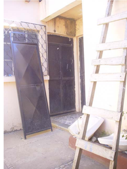
FOTO 8. El deterioro de la infraestructura se hace visible en esta grafica. AUTOR: IMAGEN PROPIA. 2,006
